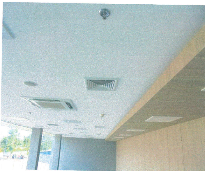
ระบบแจ้งเหตุและดับเพลิง อัตโนมัติ
