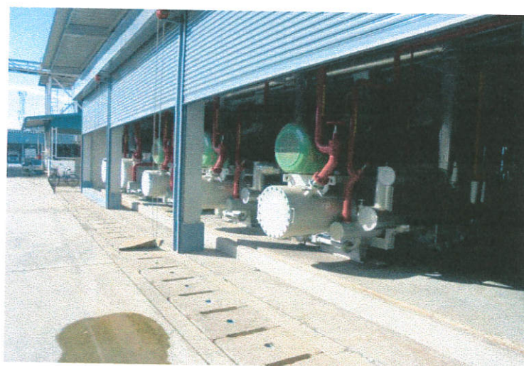
ระบบทำความเย็น
