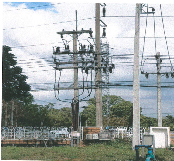
เครื่องวัดหน่วยไฟฟ้า 22 kV
