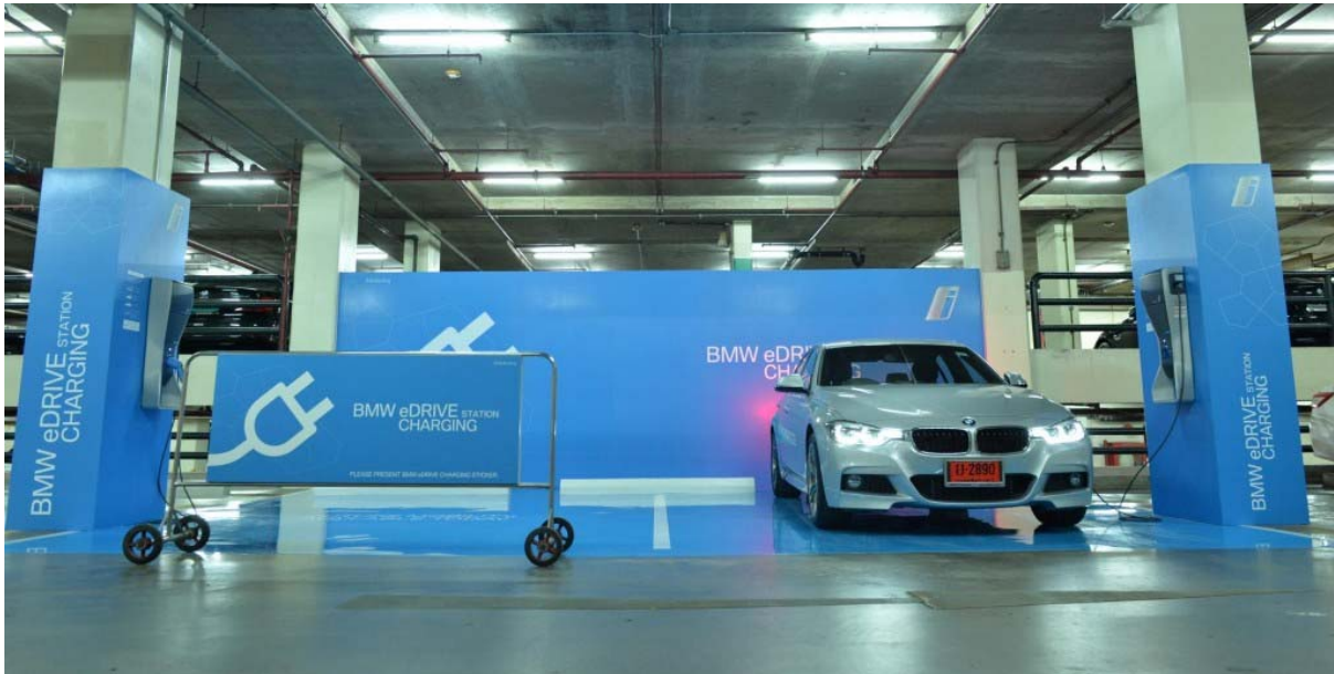
รูปที่ 5-25 สถานีบริการอัดประจุไฟฟ้าสาธารณะของเอกชน
