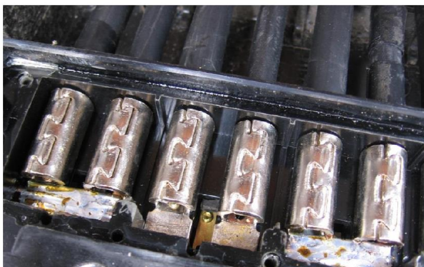
(รูปที่ ๑๑) ต่อลัดวงจร Current coil เฟส A และ C
