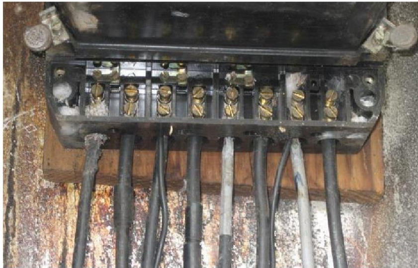
(รูปที่ ๘) การต่อไฟฟ้าไปใช้งานโดยไม่ผ่านมิเตอร์ (ต่อเฟส B-N)
