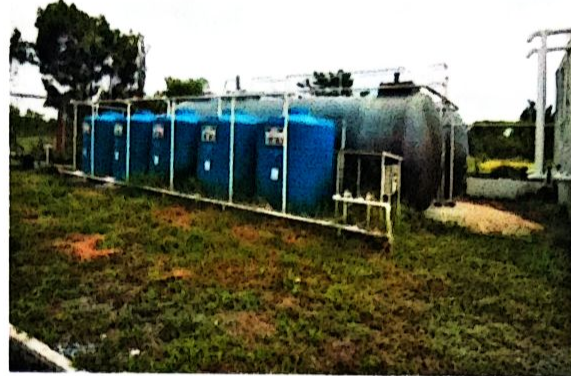
ระบบบำบัดน้ำเสีย พร้อมใช้งาน
