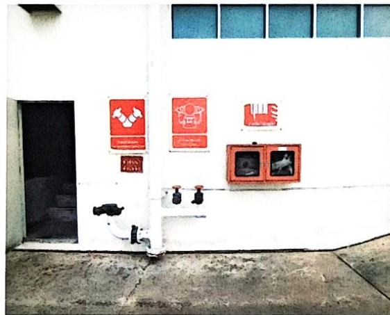
จุดรับน้ำ-จ่ายน้ำดับเพลิง พร้อมใช้งาน
