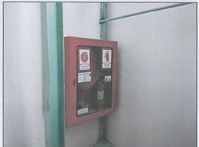
ตู้ดับเพลิง
