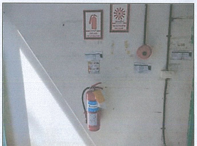
ถังดับเพลิง
