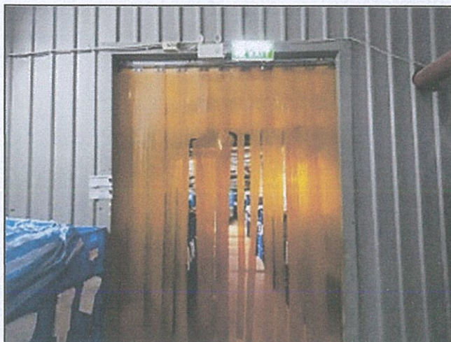
ไฟแสงสว่างฉุกเฉินและป้ายทางออก
