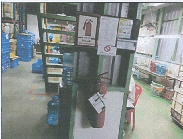
ถังดับเพลิง
