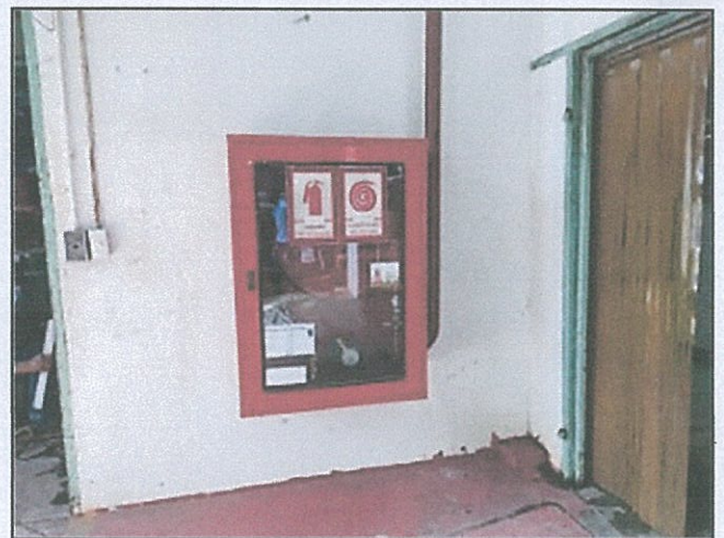
ตู้ดับเพลิง
