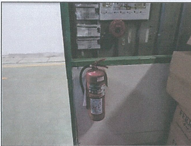
ถังดับเพลิง
