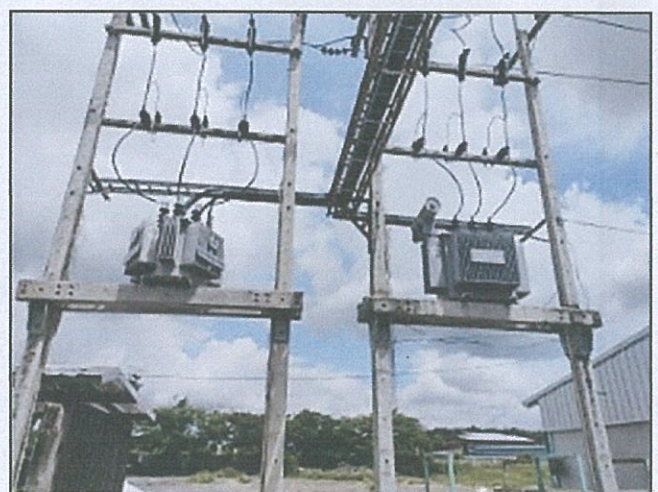
หม้อแปลงไฟฟ้า
