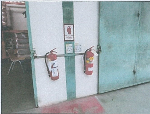
ถังดับเพลิง
