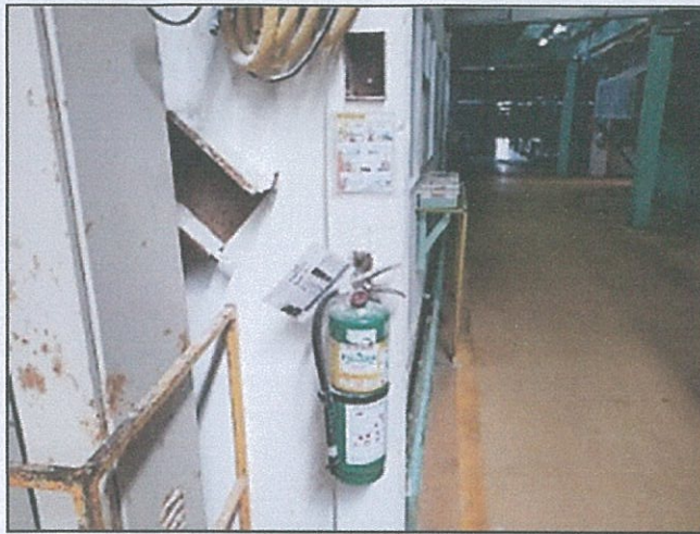
ถังดับเพลิง
