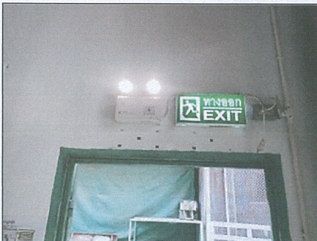
ไฟแสงสว่างฉุกเฉินและป้ายทางออก
