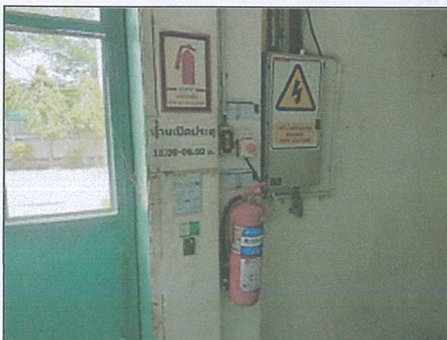
ถังดับเพลิง
