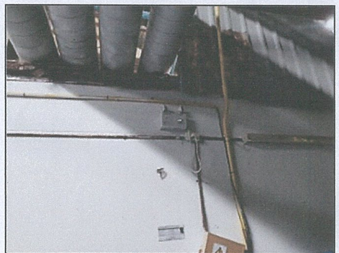
ไฟแสงสว่างฉุกเฉิน
