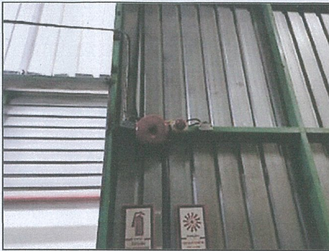
สวิตช์แจ้งเหตุฉุกเฉิน
