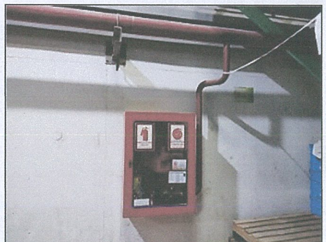
ตู้ดับเพลิง
