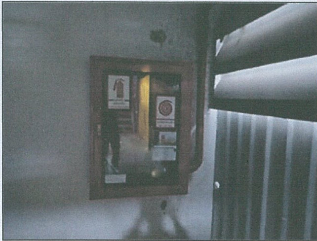
ตู้ดับเพลิง
