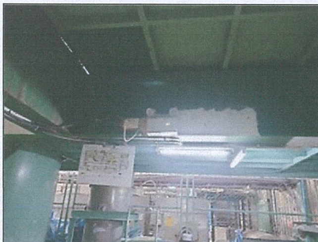
ไฟแสงสว่างฉุกเฉิน
