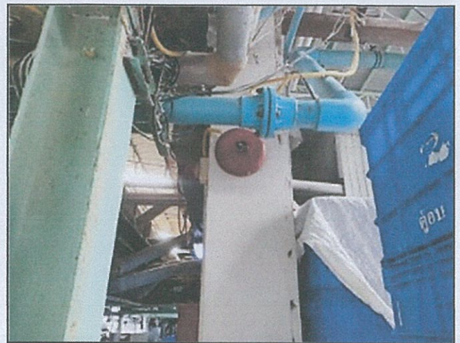
สวิตช์แจ้งเหตุฉุกเฉิน
