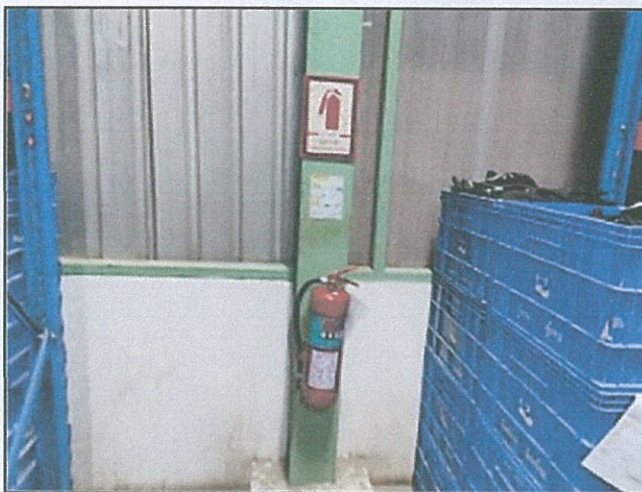
ถังดับเพลิง
