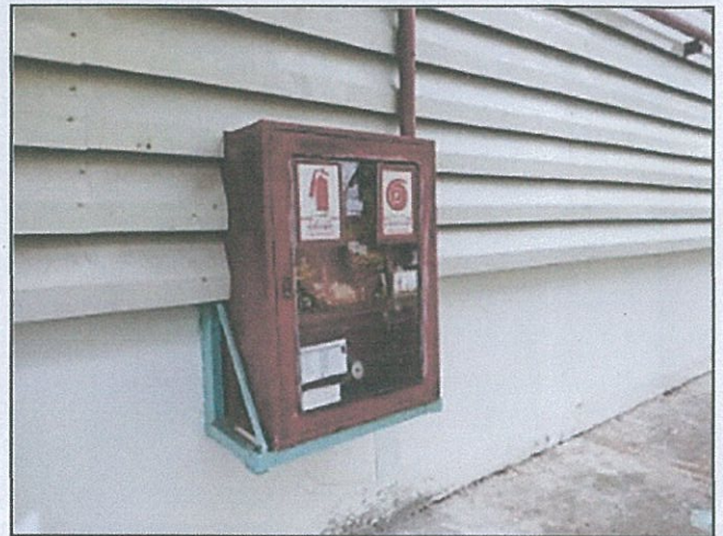
ตู้ดับเพลิง
