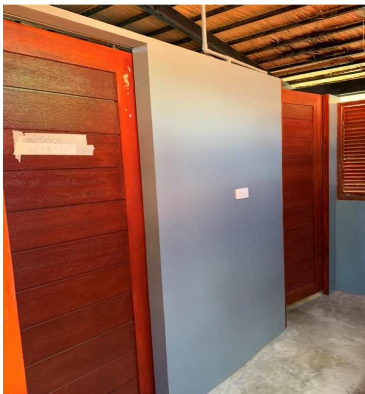
ห้องน้ำชำระ ๑ ห้องจากจำนวน ๒ ห้อง (ณ วัน ๒๐ เมษายน ๒๕๖๔ วันเข้าตรวจพื้นที่ยังไม่ได้แจ้งผู้รับจ้างดำเนินการแก้ไข)
