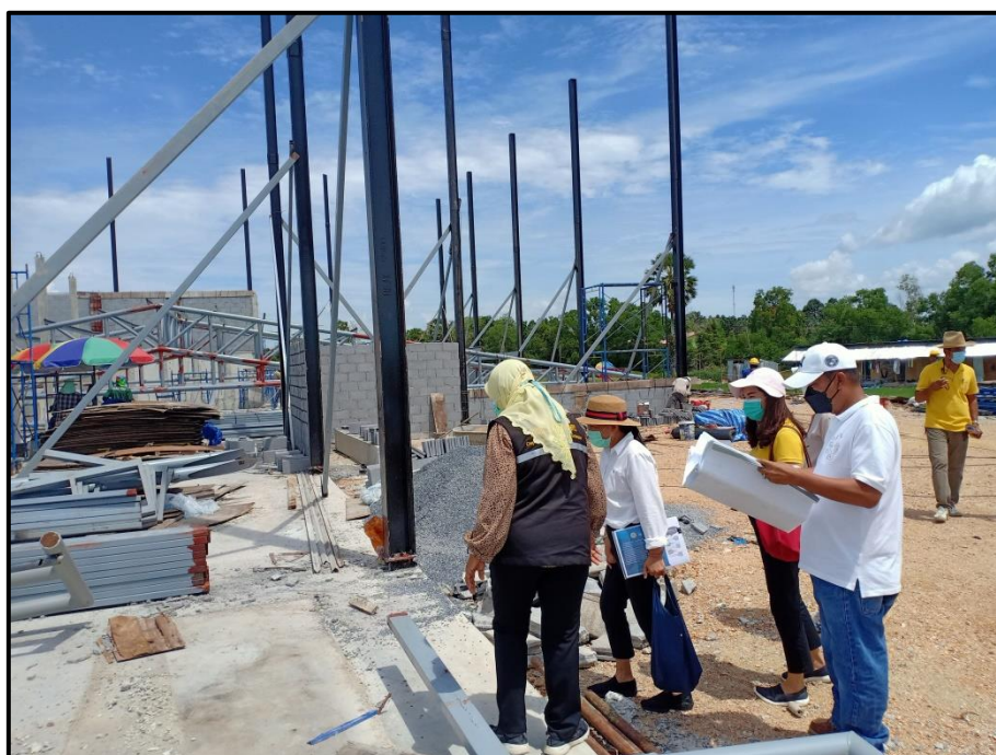
บริเวณพื้นที่สำหรับติดตั้งเครื่องจักรโรงสีข้าว
