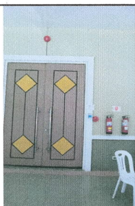
จุดแจ้งเหตุด้วยมือ และกระดิ่งแจ้งเตือนหน้าประตูที่ 2
