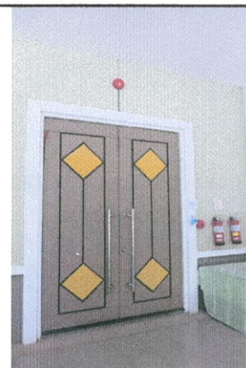
จุดแจ้งเหตุด้วยมือ และกระดิ่งแจ้งเตือนหน้าประตูที่ 1
