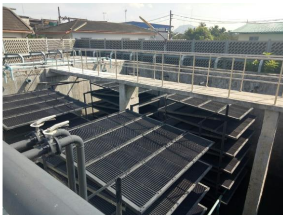
รูปที่ ๑๕ ระบบบำบัดน้ำเสียองค์การสะพานปลา
