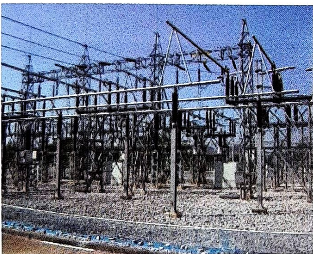
สถานไฟฟ้า
