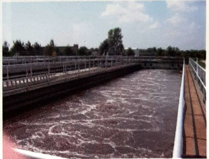
บ่อบำบัดน้ำเสีย
