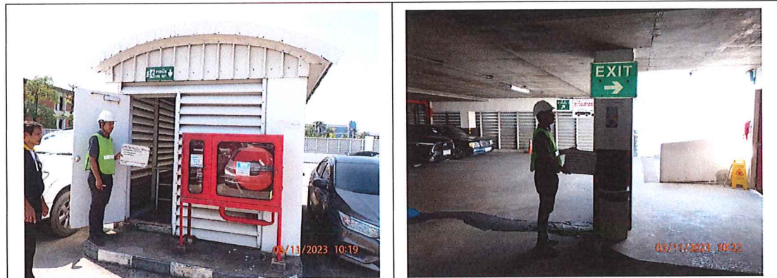
รายละเอียด ตรวจสอบภายในพื้นที่ที่มีการติดตั้งป้ายบอกทางหนีไฟในเส้นทางออกขนาดสัญลักษณ์ไม่น้อยกว่า 10 ซม. ครอบคลุมทุกพื้นที่
