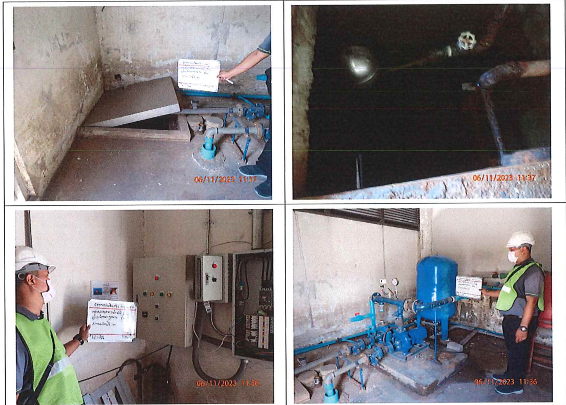
รายละเอียด ตรวจสอบสภาพถังเก็บน้ำดีของอาคารมีฝาปิดมิดชิดป้องกันการปนเปื้อน ชุดปั๊มน้ำประปาภายในอาคาร ไม่พบความผิดปกติของอุปกรณ์มีสภาพพร้อมใช้งาน
