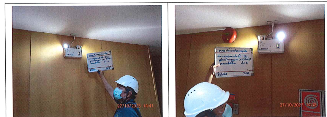
รายละเอียด อาคารการติดตั้ง ชุดไฟฟ้าแสงสว่างฉุกเฉิน (Emergency Light) ครอบคลุมทุกพื้นที่ เป็นไปตามมาตรฐานกำหนด
