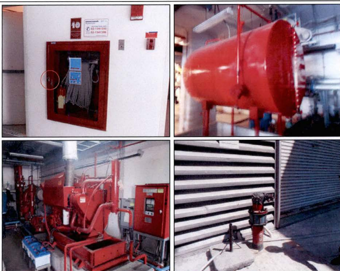
ระบบการจ่ายน้ำดับเพลิง และหัวฉีดน้ำดับเพลิง
