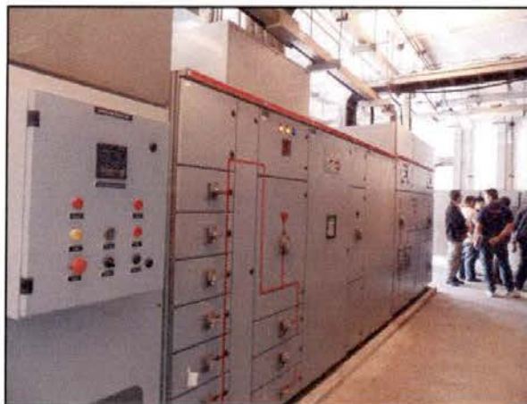
รูปแสดง สภาพระบบไฟฟ้าขณะตรวจสอบ
