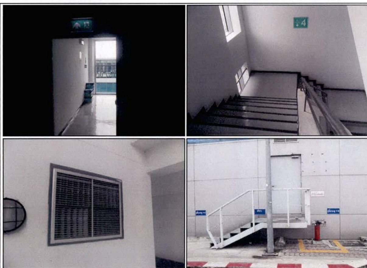
สภาพระบบบันไดหนีไฟและทางหนีไฟ
