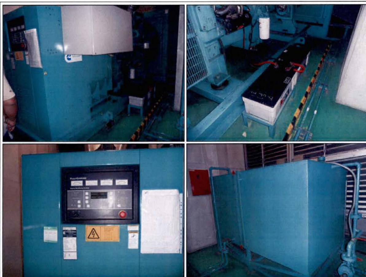
สภาพระบบเครื่องกำเนิดไฟฟ้าสำรองฉุกเฉิน
