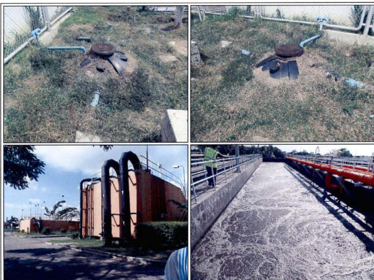
ระบบระบายน้ำเสียและบำบัดน้ำเสีย
