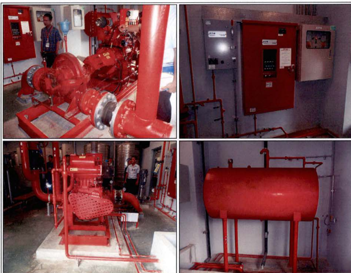
ระบบการจ่ายน้ำดับเพลิง
