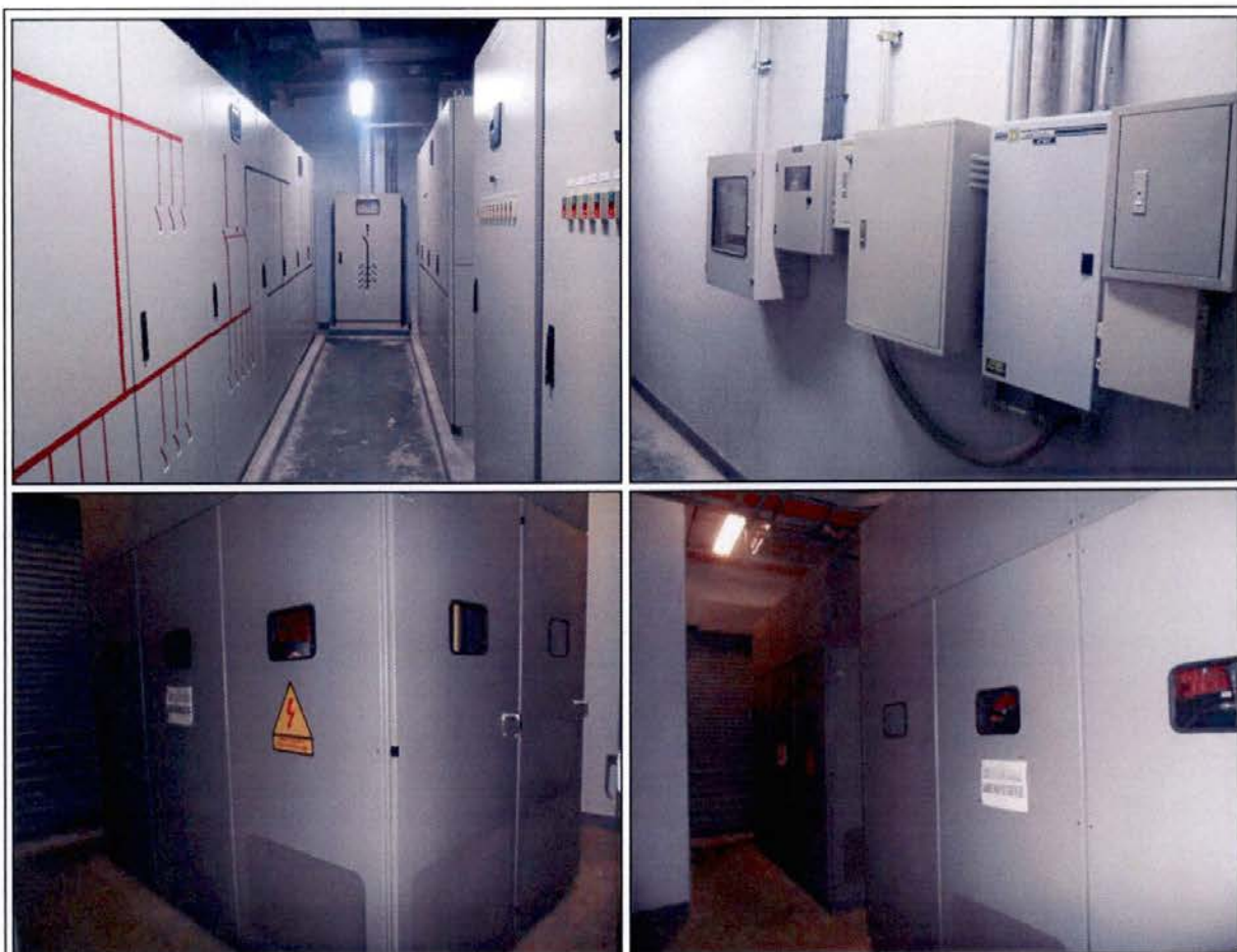
สภาพระบบไฟฟ้าขณะตรวจสอบ
