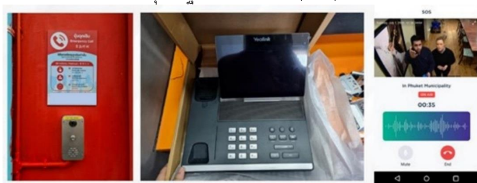
รูปภาพที่ 8-10 ตัวอย่างระบบแจ้งเหตุและขอความช่วยเหลือฉุกเฉิน ( Emergency Call) รับแจ้งเหตุ 24 ชั่วโมง ผ่านระบบ IP phone ที่ห้องควบคุมเฝ้าระวัง สุรเชษฐ์ หักพาลและคณะ (2565)
