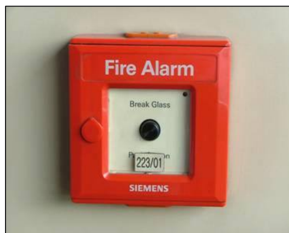
รูปที่ 2.5-1 ตัวอย่างอุปกรณ์ Manual Station
