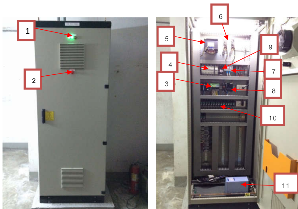
รูปที่ 3.2 ตู้ควบคุม(RW Control Panel)
