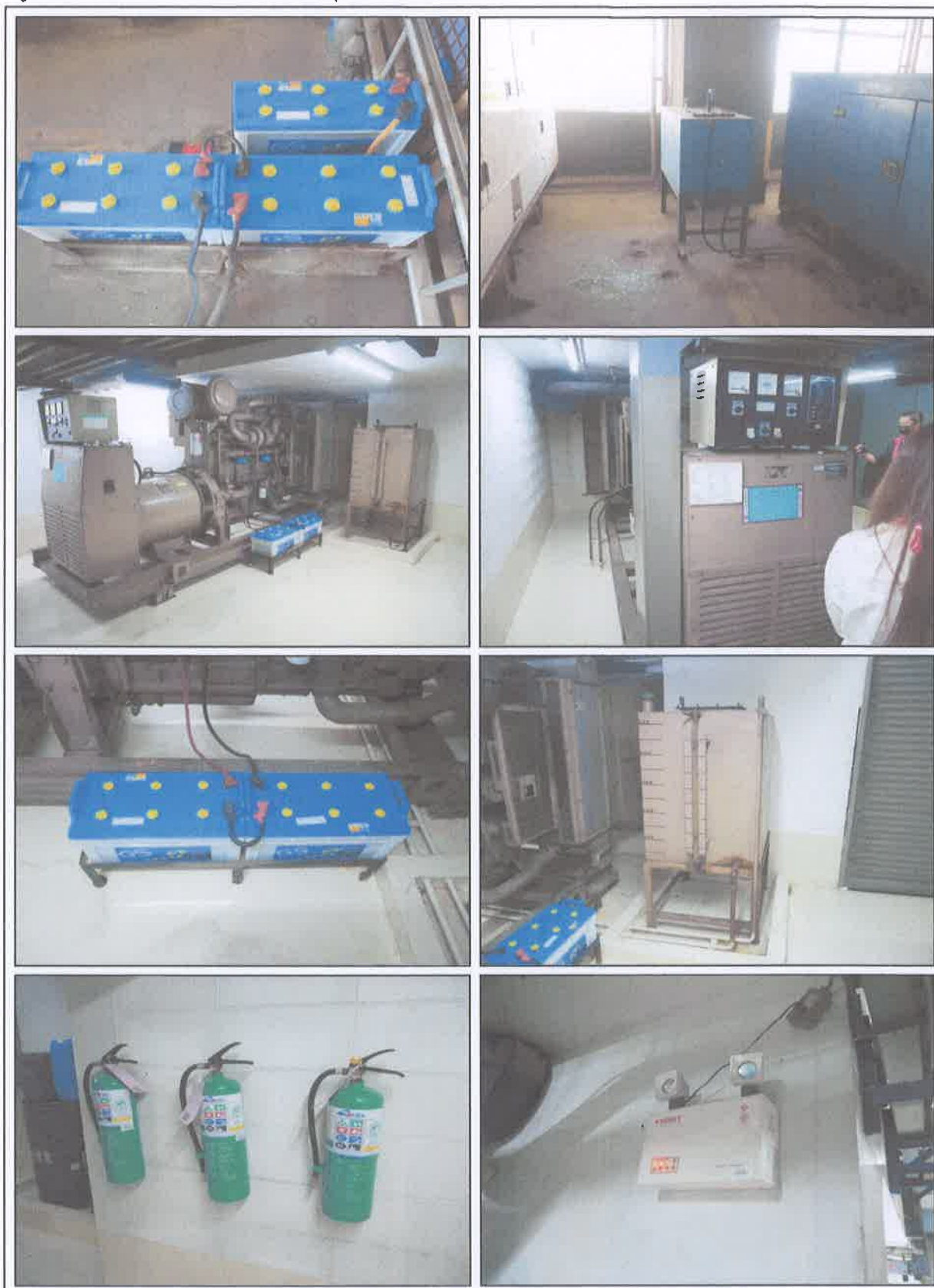
รูปแสดง สภาพของระบบไฟฟ้าสำรองฉุกเฉิน ขณะตรวจสอบ (ต่อ)
