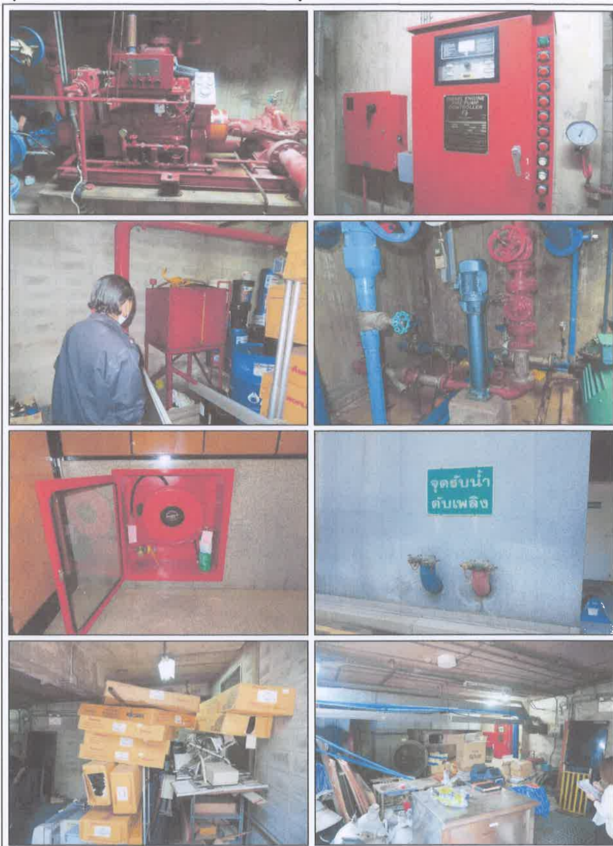
รูปแสดง สภาพของระบบการจ่ายน้ำดับเพลิง เครื่องสูบน้ำดับเพลิง และหัวฉีดน้ำดับเพลิง ขณะตรวจสอบ
