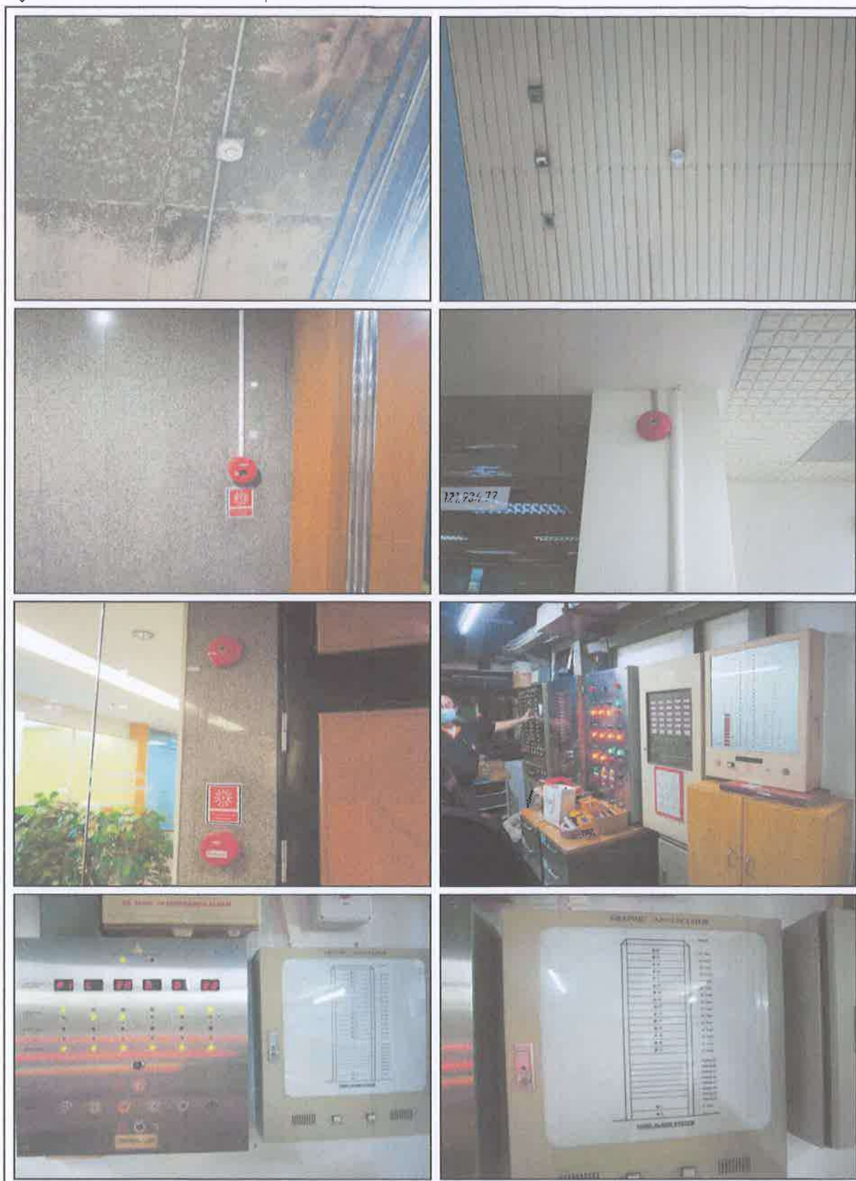
รูปแสดง สภาพของระบบแจ้งเหตุเพลิงไหม้ ขณะตรวจสอบ
