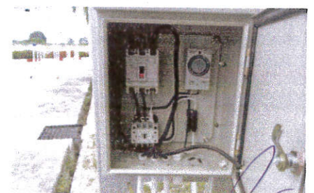
แผงควบคุมไฟฟ้า
