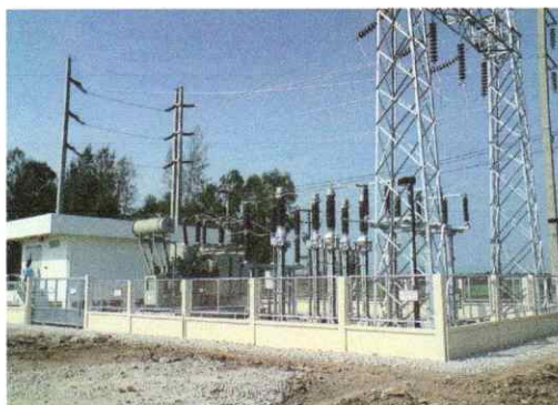
สถานไฟฟ้า
