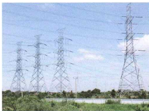
เสาไฟฟ้า
