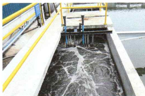
บำบัดน้ำเสีย
