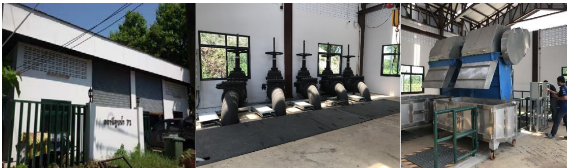
ภาพที่ ๓ สถานีสูบน้ำเสียเทศบาลเมืองบุรีรัมย์
