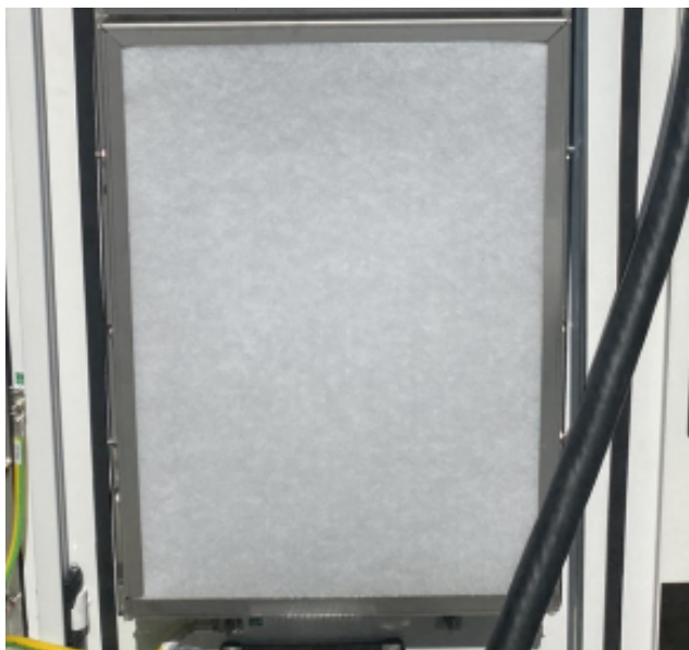
รูปที่ 2 แผ่น Filter ภายในเครื่องอัดประจุ
