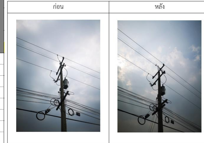
1. หม้อแปลง PEA 47-004616 ขนาด 30kVA
