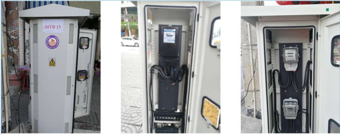
รูปภาพ Meter Box 400/230 V (MTB)
