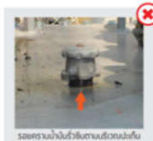
รอยคราบน้ำมันรั่วซึมตามบริเวณปะเก็น
