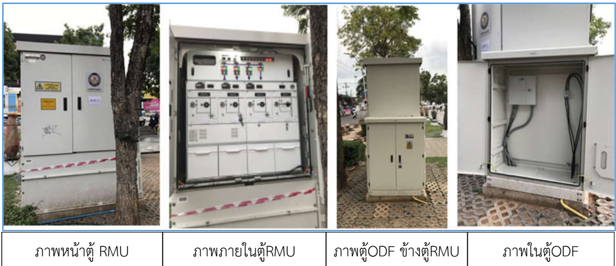
รูปภาพ ตู้ Ring main Unit 22 kV และตู้ระบบสื่อสาร
