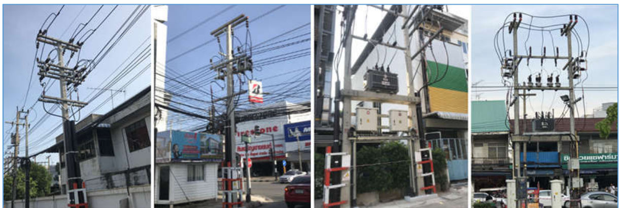
รูปภาพ Riser Pole 22 kV
