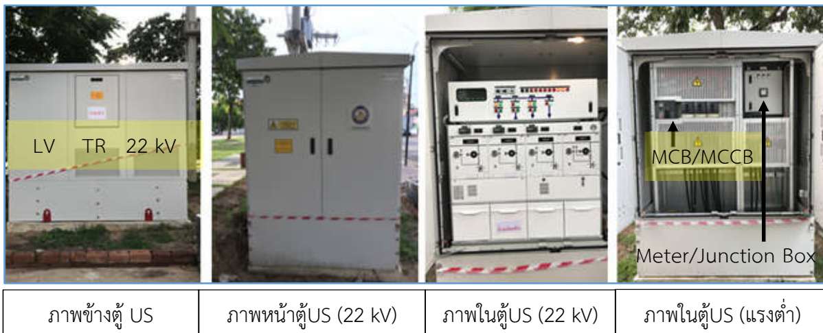
รูปภาพ ภาพตู้ Unit Substation
