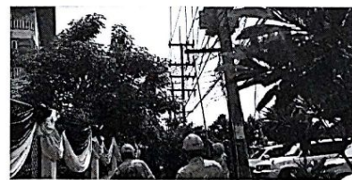
ทีมแก้กระแสไฟฟ้าขัดข้อง ปลดไฟฟ้าที่จ่ายให้
