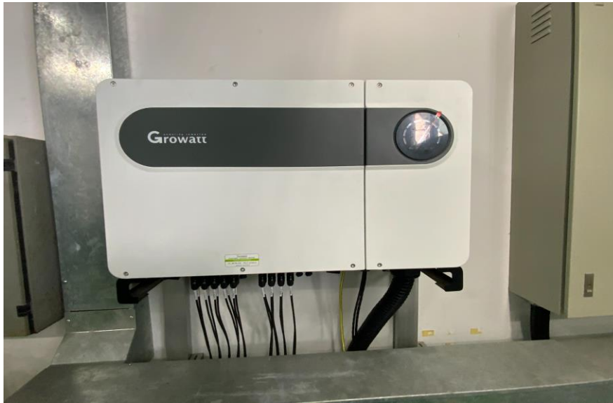
รูปการณติดตั้งแผง Solar Cell และ Inverter
