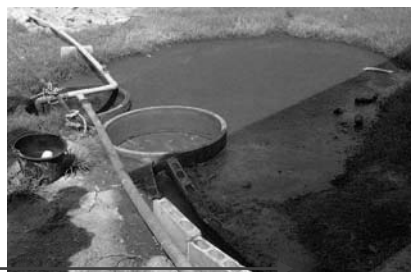
รูปที่ 7.2-4 ระบบรวบรวมน้ำเสีย ที่น้ำเสียเอ่อล้นออกนอกรางและบ่อรวบรวมน้ำเสีย
