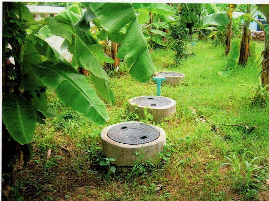
ภาพที่ 2.1-6 สภาพทั่วไปของระบบบำบัดน้ำเสียสำเร็จรูปของโรงฆ่าโค
