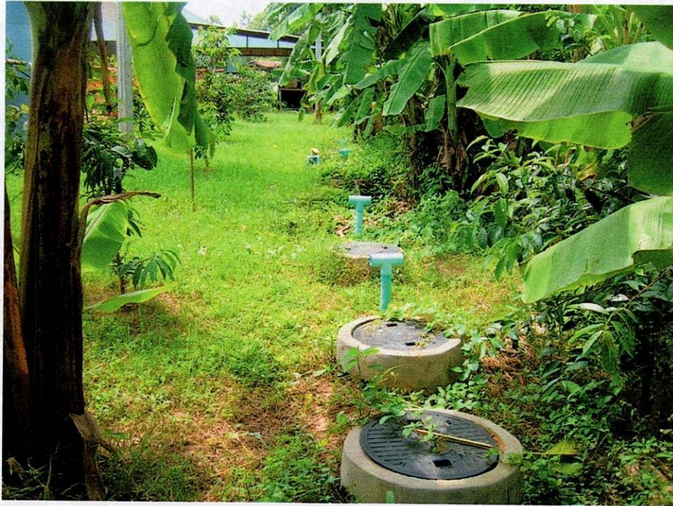
ภาพที่ 2.1-5 สภาพทั่วไปของระบบบำบัดน้ำเสียสำเร็จรูปของโรงฆ่าสุกร
