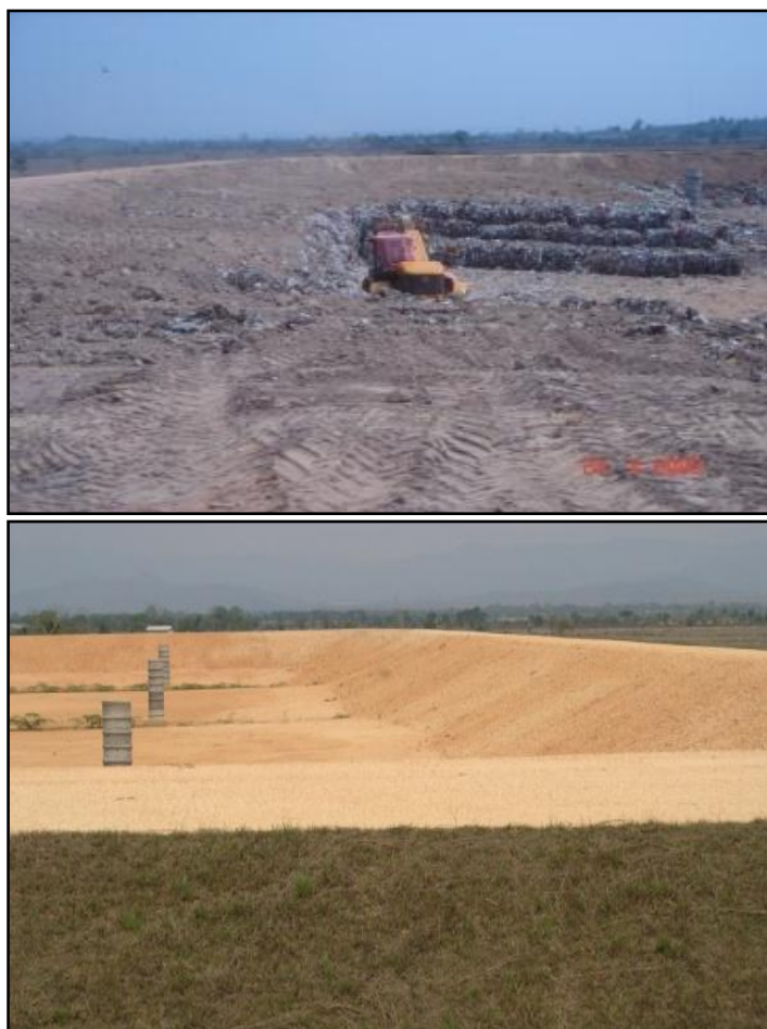
ภาพที่ 4.9 สถานที่กำจัดมูลฝอยชุมชนโดยการฝังกลบอย่างถูกหลักสุขาภิบาล
