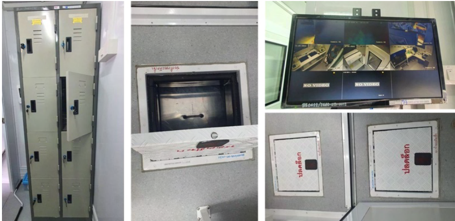
รูปที่ 32 เครื่องมือและอุปกรณ์ภายในห้องควบคุม/ห้องอเนกประสงค์ และห้องบัฟเฟอร์
