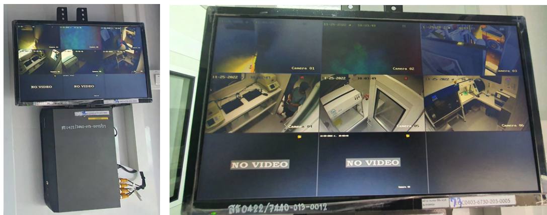
รูปที่ 25 ตู้ควบคุม และจอมอนิเตอร์วงจรปิด
