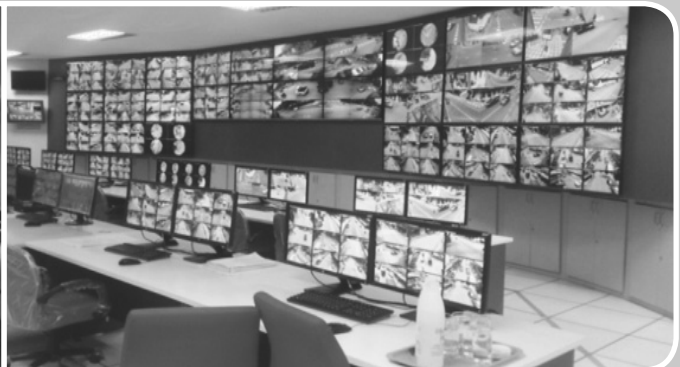
ห้อง Control Room เทศบาลนครเชียงใหม่
