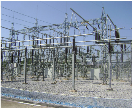
ลานไฟฟ้า
