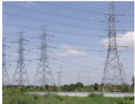
เสาไฟฟ้า
