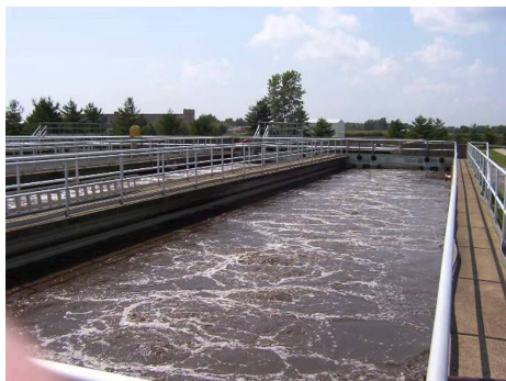
บ่อบำบัดน้ำเสีย
