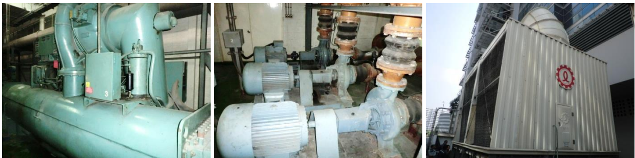
ภาพอุปกรณ์ระบบทำน้ำเย็นที่ลดการใช้งาน (เครื่องทำน้ำเย็น, ปั๊มน้ำหล่อเย็น และหอผึ่งเย็น)
