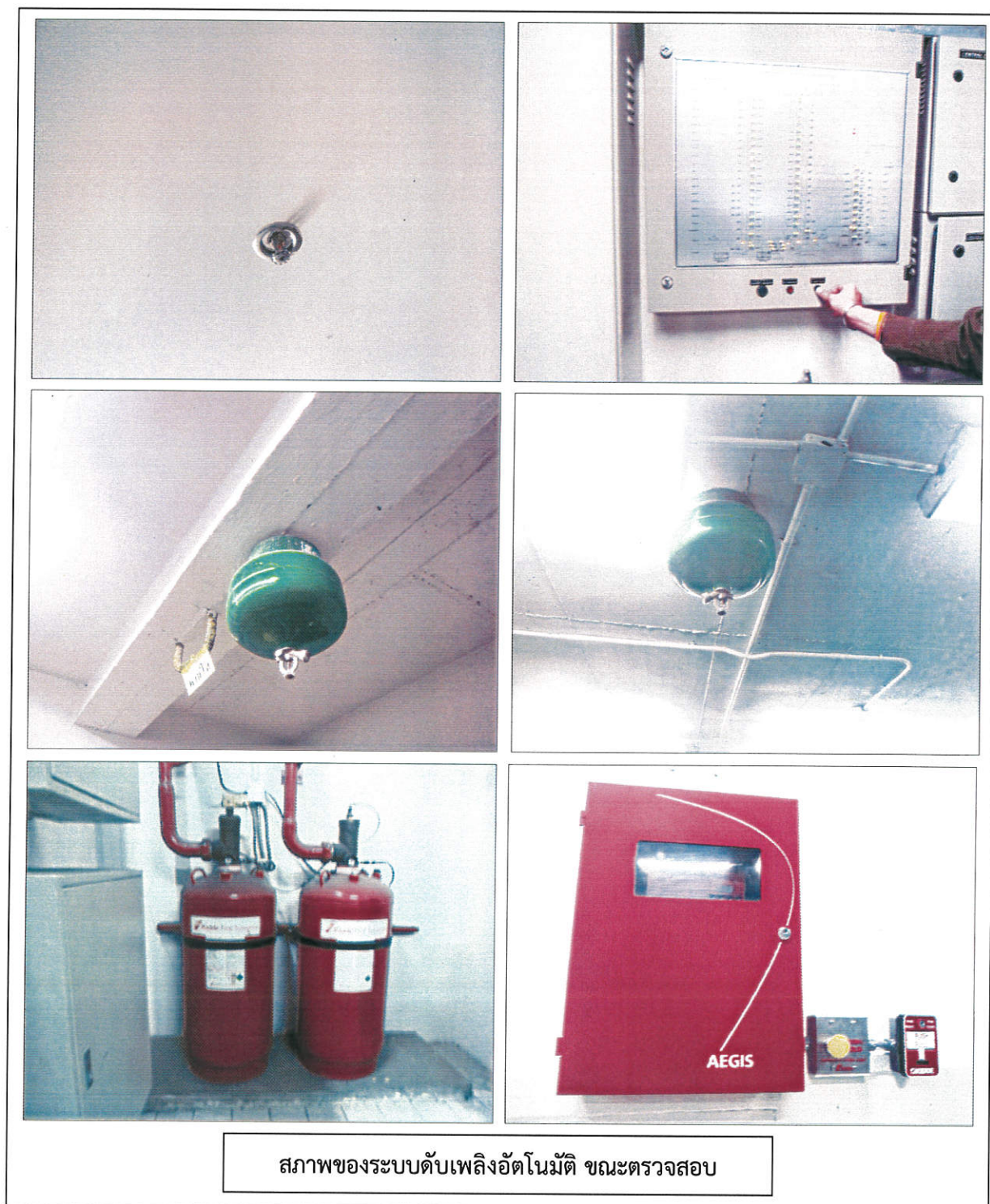
รูปแสดง สภาพของระบบดับเพลิงอัตโนมัติ ขณะตรวจสอบ
