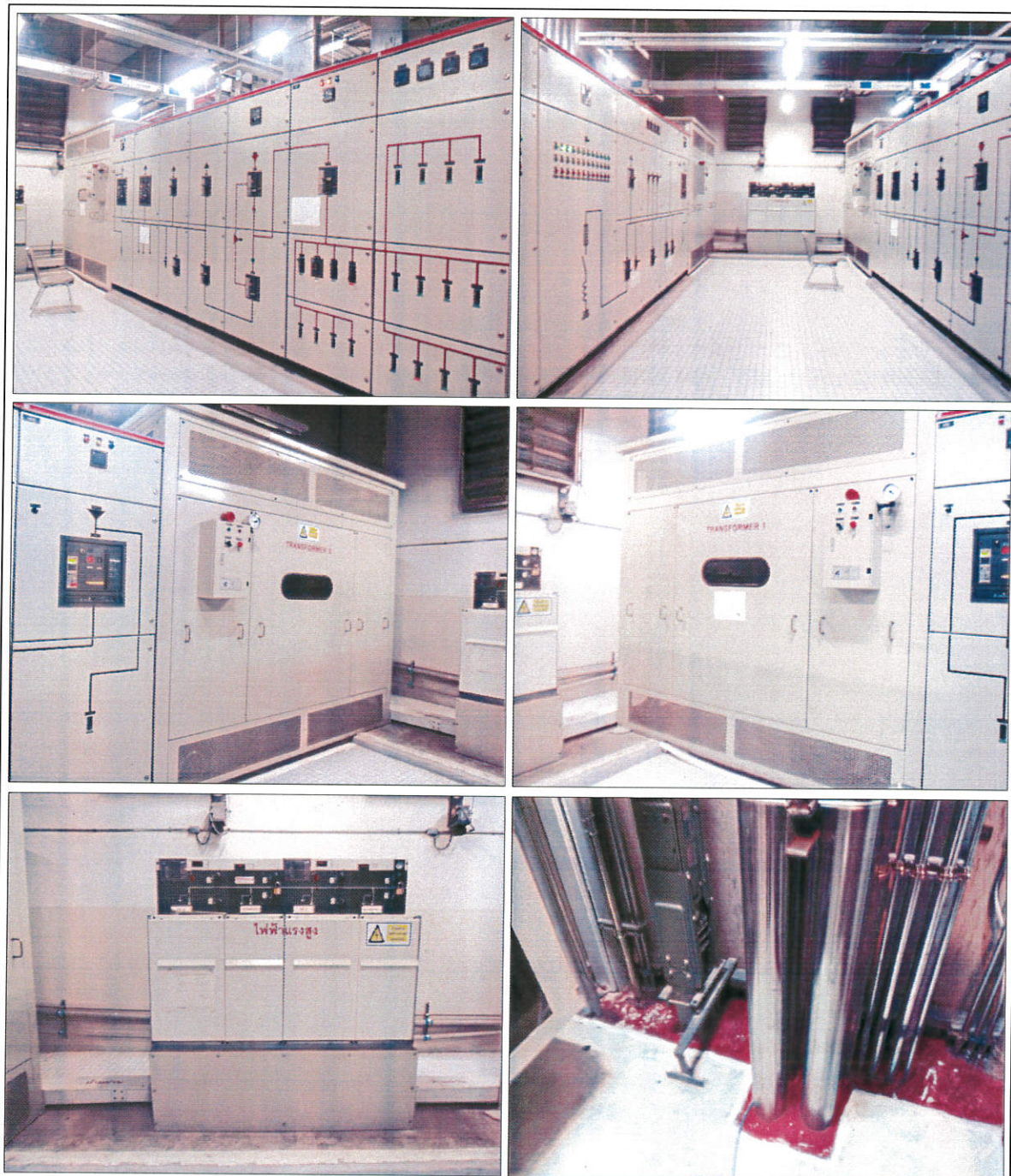
สภาพระบบไฟฟ้า ขณะตรวจสอบ
