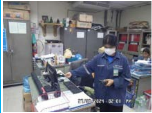
อาคารซ่อมบำรุงไฟฟ้า ห้องส่วนไฟฟ้ากำลัง 1 โต๊ะทำงานคุณวิฑูรย์ พิมพ์ทอง
