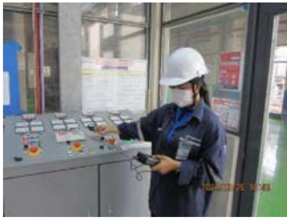
โรงสูบน้ำ 2 Control Room Pump Control Desk (คุณชูตระกูล กิจพันธ์)
