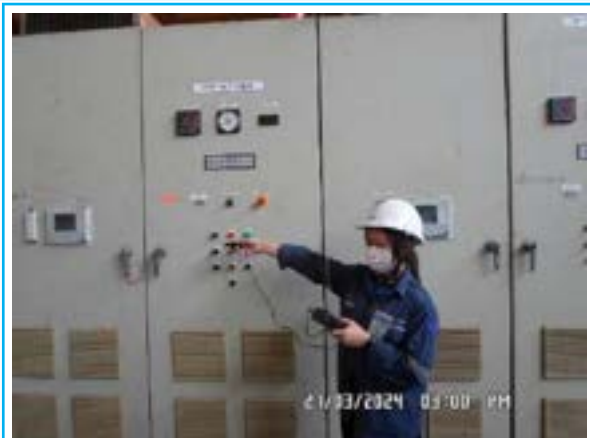
โรงสูบน้ำล่าง 2 เครื่อง VVVF No.1
