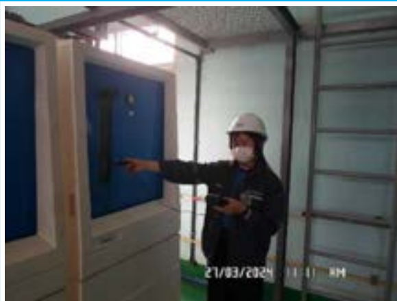
โรงจ่ายคลอรีน 3 Chlorinator No.1
