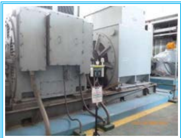
โรงสูบน้ำดิบ 1
