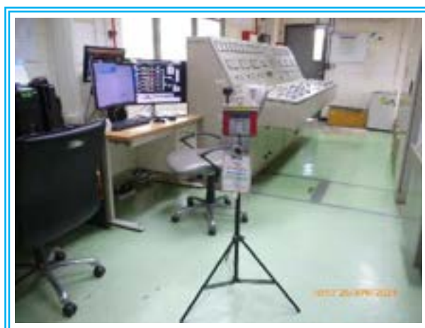
โรงสูบน้ำส่งน้ำ 3
