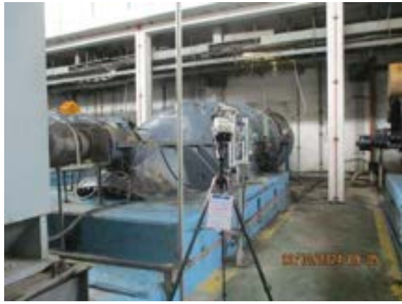
โรงสูบน้ำดิบ 1
