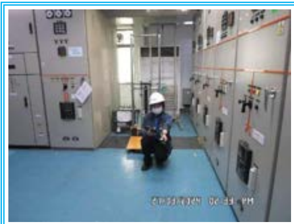
โรงสูบน้ำดิบ 2 SWG Room ทางเดิน SWG Room (P1)
