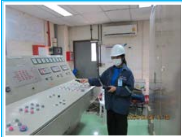
โรงสูบน้ำส่งน้ำ 3 Control Room Pump Control No.1 (คุณเลอสร สโมสร)
