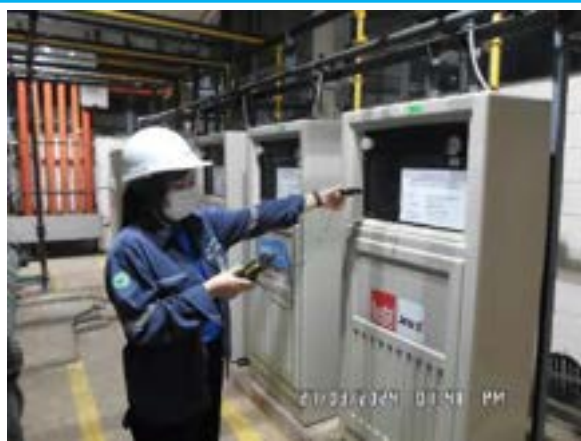
โรงจ่ายคลอรีน 1 Chlorinator No.1
