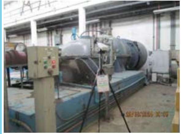
โรงสูบน้ำดิบ 2
