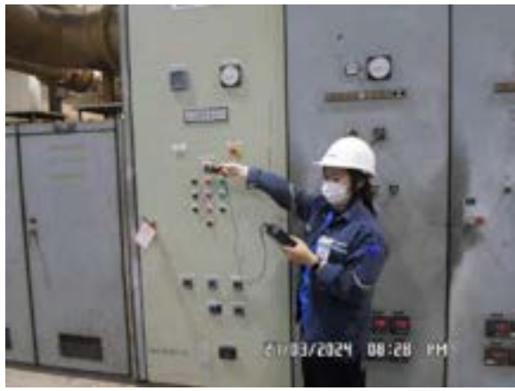
โรงสูบน้ำล่าง 1 Blower No.1
