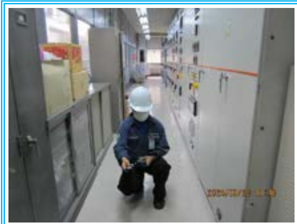
โรงสูบน้ำจ่ายน้ำ 1 SWG Room 2 ทางเดิน SWG Room 2 (P1)
