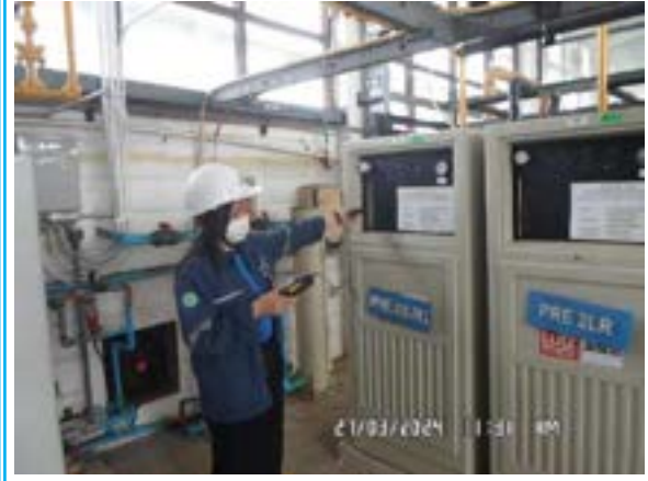
โรงจ่ายคลอรีน 2 Chlorinator No.1
