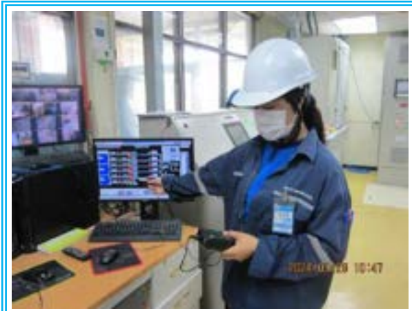
โรงสูบน้ำส่งน้ำ 2 Control Room โต๊ะคอมพิวเตอร์ No.1 (คุณธนพล บุพนิมิตร)
