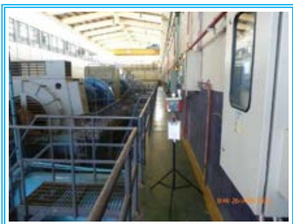
โรงสูบน้ำส่งน้ำ 1
