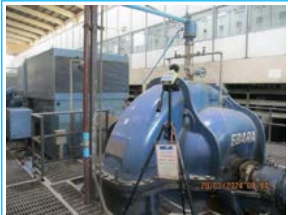
โรงสูบน้ำส่งน้ำ 2
