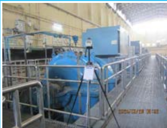
โรงสูบน้ำส่งน้ำ 3
