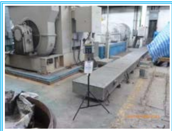
โรงสูบน้ำดิบ 2
