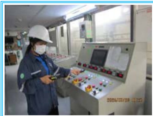
โรงสูบน้ำส่งน้ำ 1 Control Room เครื่อง Plant Water No.1 (คุณวุฒิชัย จินะงาม)
