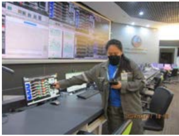
อาคารอำนวยการชั้น 3 Center Control Room โต๊ะคอมพิวเตอร์ No.4 (คุณขจร รongสกุล)
