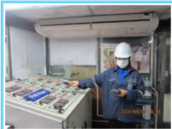
โรงสูบน้ำจ่ายน้ำ 1 Control Room Stat Pump 1 (คุณฐิติ นิลวรรณ)
