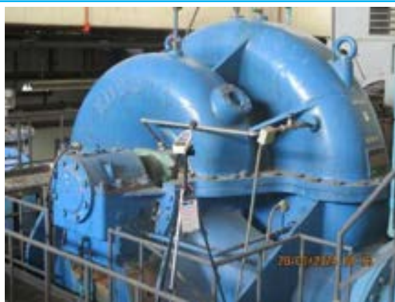
โรงสูบน้ำส่งน้ำ 1
