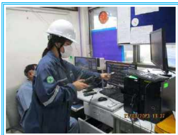
โรงสูบน้ำดิบ 1 โต๊ะคอมพิวเตอร์ No.2 (คุณคุณานนท์ งามถ้อย)
