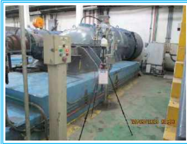
โรงสูบน้ำดิบ 2
