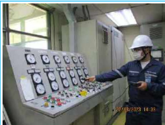
โรงสูบน้ำ 2 Plant Water Pump No. 1
