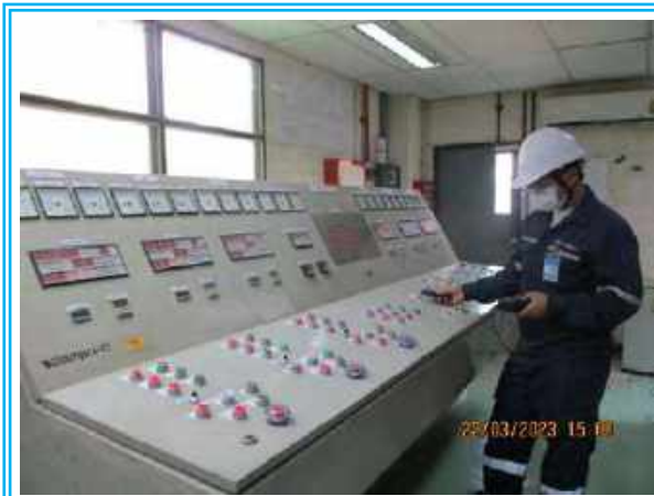
โรงสูบน้ำ 3 Pump Control No.1
