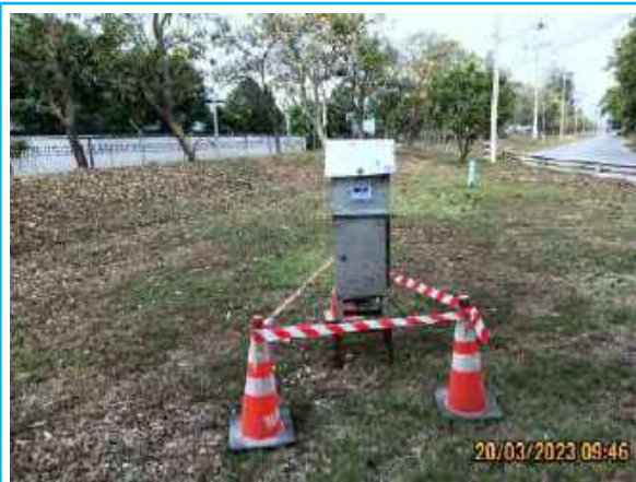
ถนนบริเวณกองควบคุมระบบกำจัดตะกอน จุดที่ 1 บ่อม ปรก. ประตุ 3
