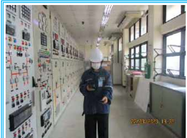
สถานีไฟฟ้าย่อย 1B Switchgear Room
