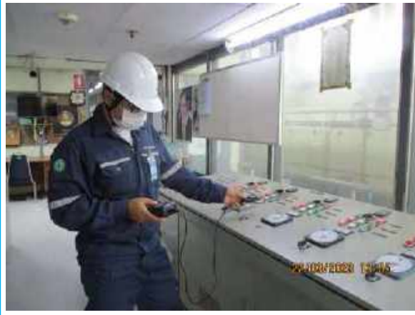
โรงสูบน้ำ 1 เครื่อง Stat Pump No.1
