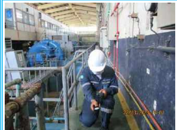
โรงสูบน้ำ 1 ทางเดินโรงสูบน้ำ 1
