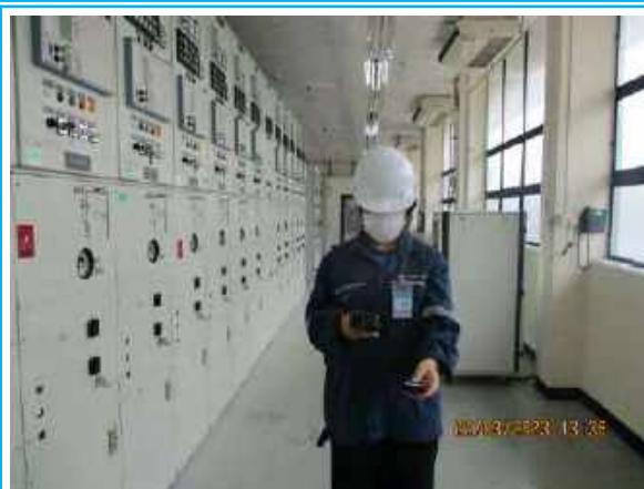
สถานีไฟฟ้าย่อย 1A Switchgear Room
