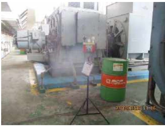
โรงสูบน้ำดิบ 1
