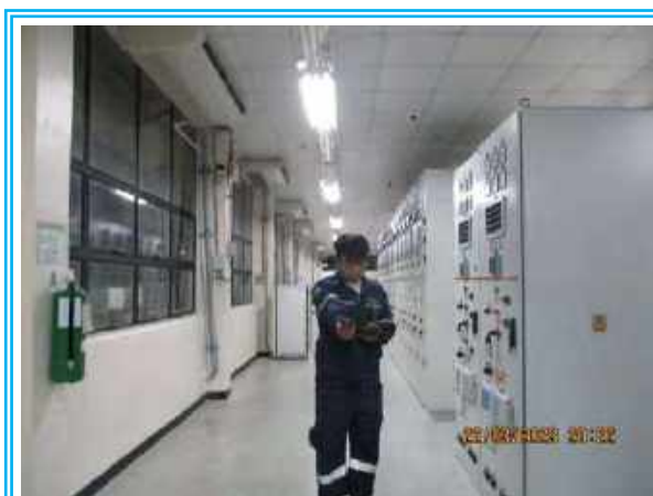
สถานีไฟฟ้าย่อย 1A Switchgear Room
