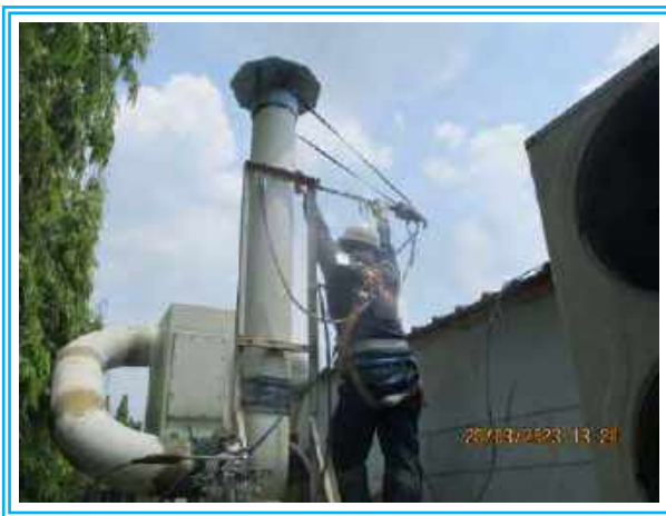
บริเวณปล่องห้องวิเคราะห์คุณภาพน้ำระบบผลิต
