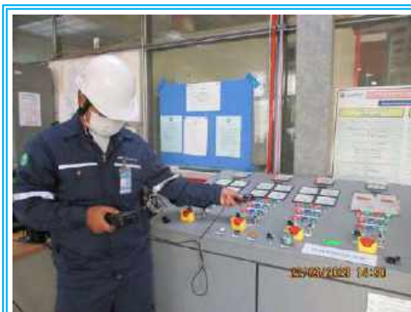
โรงสูบน้ำ 2 Pump Control Desk
