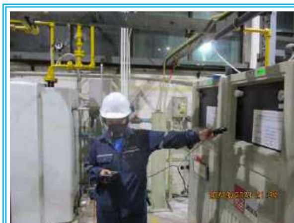
โรงจ่ายคลอรีน 2 Chlorinator No.1
