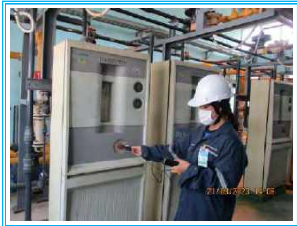
โรงจ่ายคลอรีน 3 Chlorinator No.6
