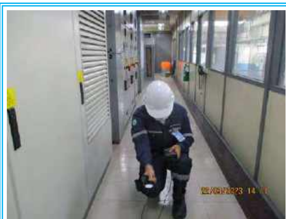
โรงสูบน้ำ 1 ทางเดิน SWG Room 1
