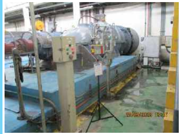
โรงสูบน้ำดิบ 2
