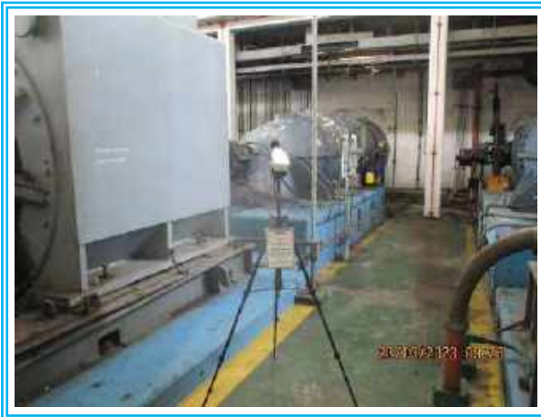
โรงสูบน้ำดิบ 1
