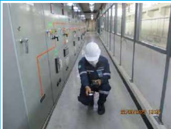
โรงสูบน้ำ 1 ทางเดิน SWG Room
