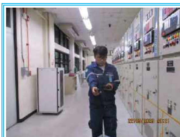
สถานีไฟฟ้าย่อย 1B Switchgear Room
