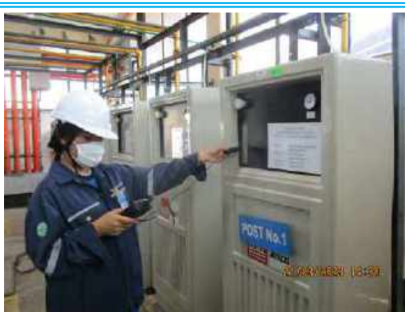
โรงจ่ายคลอรีน 1 Chlorinator No.1
