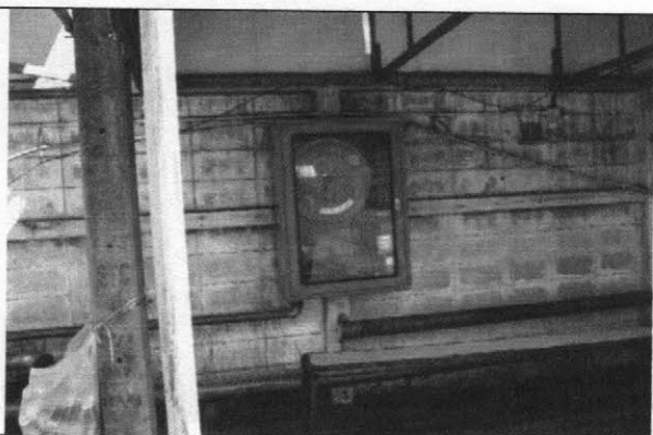
ตู้ดับเพลิง
