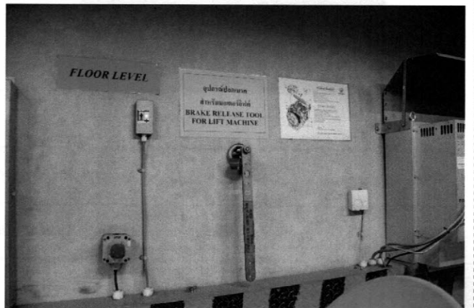
รูปแสดงอุปกรณ์ช่วยเหลือกรณีลิฟต์ค้าง
