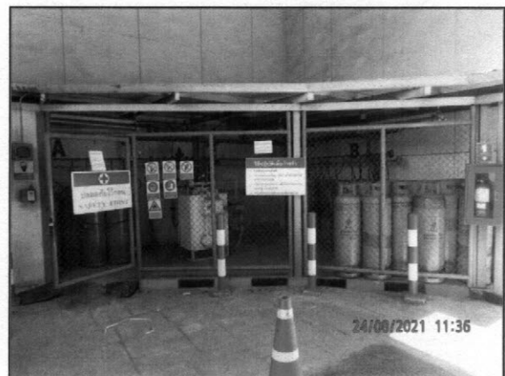
LPG บริเวณด้านหลังอาคาร
