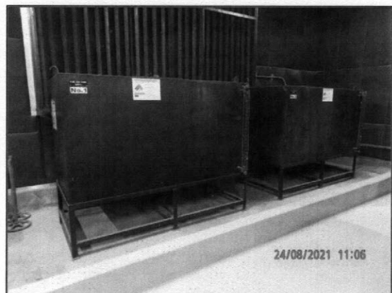
น้ำมันดีเซลห้องเครื่องกำเนิดไฟฟ้า
