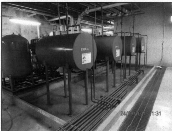
น้ำมันดีเซลห้องเครื่องสูบน้ำดับเพลิง
