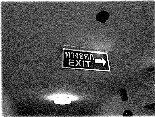
ชั้น 12 - บ้ายแสดงเส้นทางหนีไฟ
