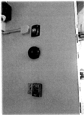
ชั้น 3 - สัญญาณแจ้งเหตุเพลิงไหม้
