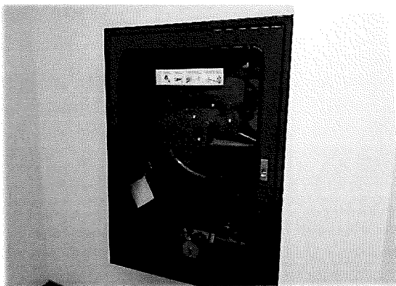
ชั้น 12 - ตู้ดับเพลิงและสายฉีดน้ำดับเพลิง
