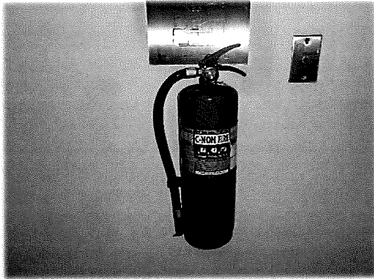
ชั้น 22 - ถังดับเพลิงเคมีชนิดมือถือ
