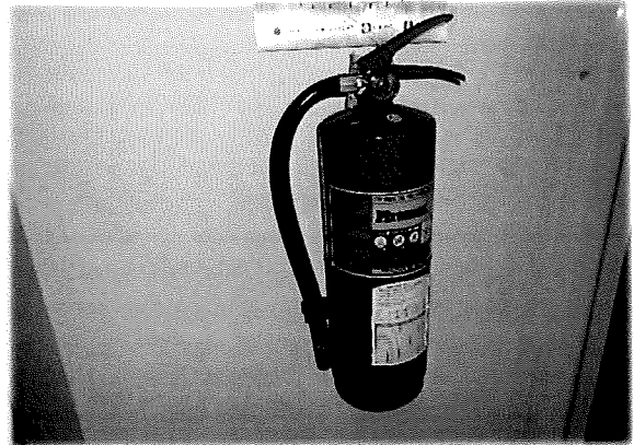
ชั้น 3 - ถังดับเพลิงเคมีชนิดมือถือ
