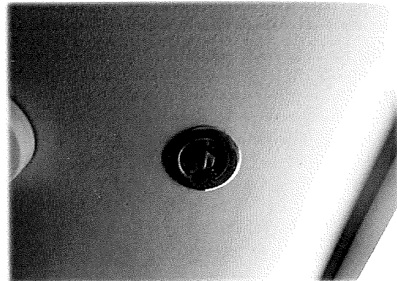
ชั้น 12 - สปริงเกอร์
