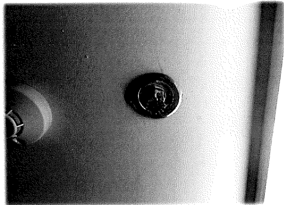
ชั้น 22 - สปริงเกอร์
