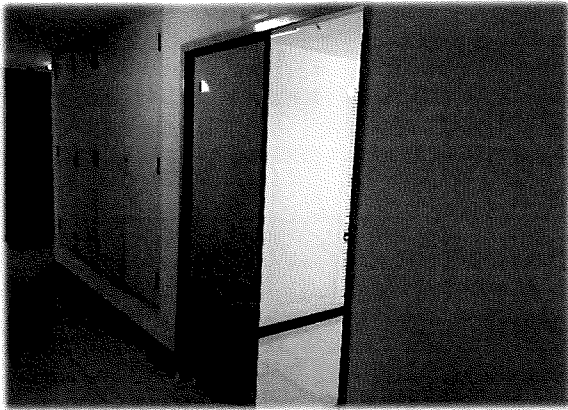
ชั้น 18 - ประตูเข้า-ออก ห้องลิฟต์หนีไฟ
