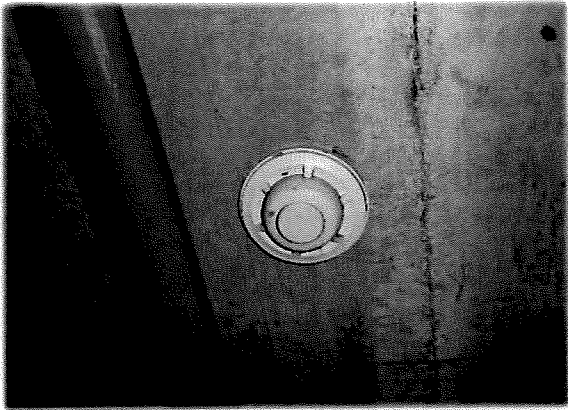
ชั้น 3 - อุปกรณ์ตรวจจับควัน
