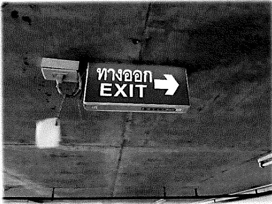
ชั้น 3 - บ้ายแสดงเส้นทางหนีไฟ
