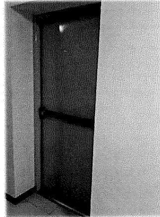
ชั้น 12 - ประตูหนีไฟ
