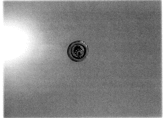
ชั้น 22 - สปริงเกอร์
