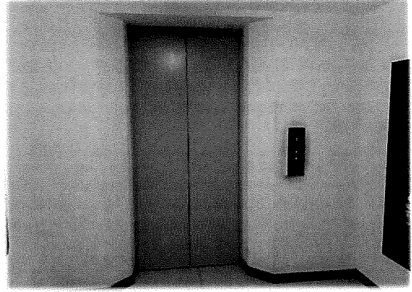
ชั้น 18 - ลิฟต์หนีไฟ
