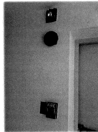
ชั้น 22 - สัญญาณแจ้งเหตุเพลิงไหม้
