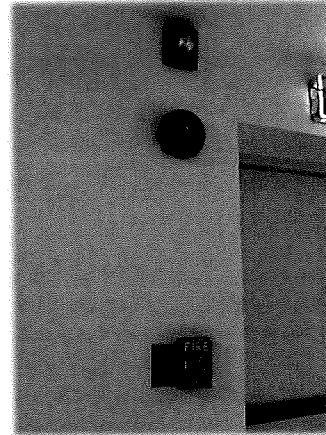
ชั้น 12 - สัญญาณแจ้งเหตุเพลิงไหม้
