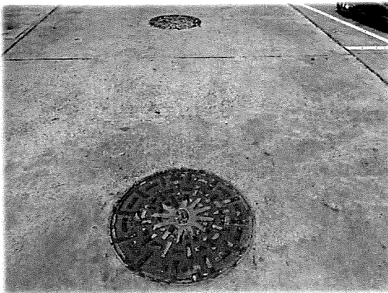
ท่อบำบัดน้ำเสีย
