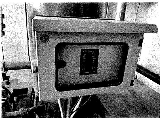
ชั้นดาดฟ้า - ตู้ควบคุมกระแสไฟฟ้าปั๊มเพิ่มแรงดันน้ำ
