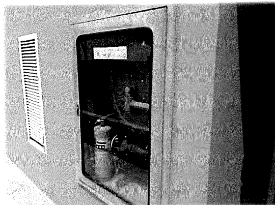
ชั้นดาดฟ้า - ตู้ดับเพลิงเคมีชนิดมือถือ
