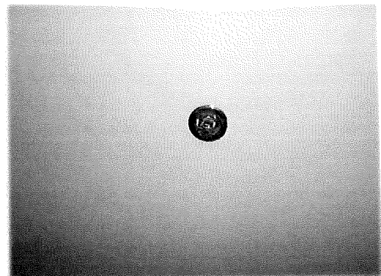
ชั้น 22 - สปริงเกอร์
