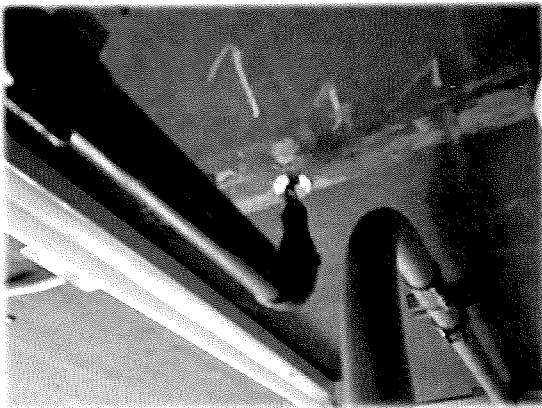
ชั้นดาดฟ้า - สปริงเกอร์
