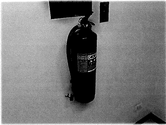
ชั้น 18 - ถังดับเพลิงเคมีชนิดมือถือ
