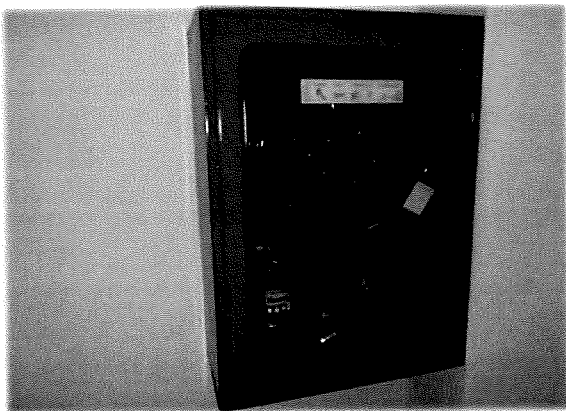
ชั้น 22 - ตู้ดับเพลิงและสายฉีดน้ำดับเพลิง
