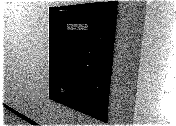
ชั้น 18 - ตู้ดับเพลิงและสายฉีดน้ำดับเพลิง
