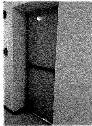
ชั้น 22 - ประตูหนีไฟ
