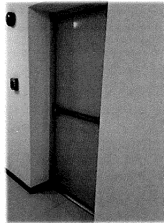
ชั้น 18 - ประตูหนีไฟ
