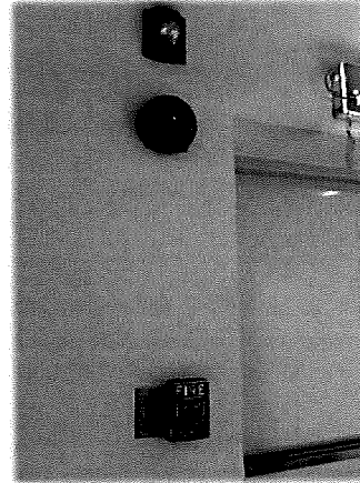
ชั้น 18 - สัญญาณแจ้งเหตุเพลิงไหม้
