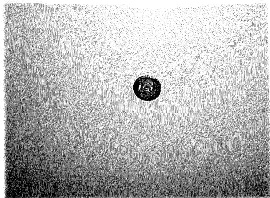
ชั้น 22 - สปริงเกอร์
