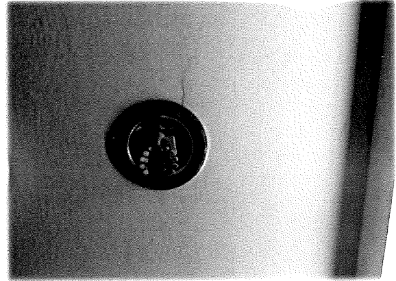
ชั้น 18 - สปริงเกอร์
