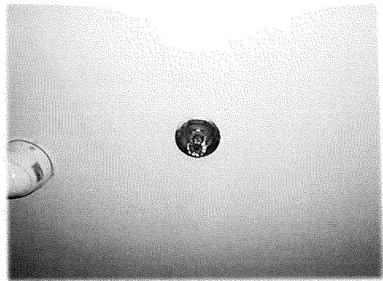
ชั้น 12 - สปริงเกอร์
