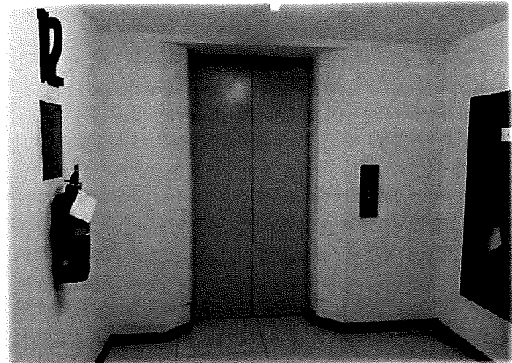
ชั้น 12 - ลิฟต์หนีไฟ
