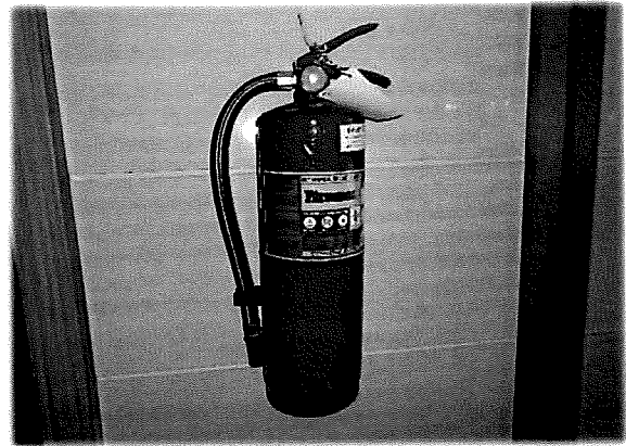
ชั้น G - ถังดับเพลิงเคมีชนิดมือถือ
