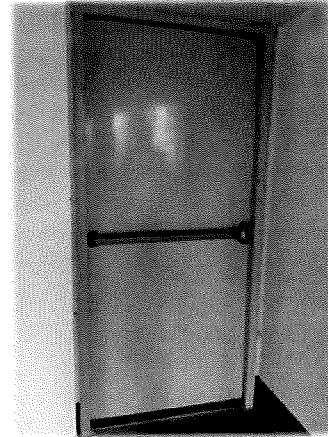
ชั้น 3 - ประตูหนีไฟ
