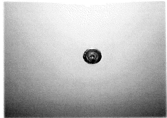
ชั้น 18 - สปริงเกอร์
