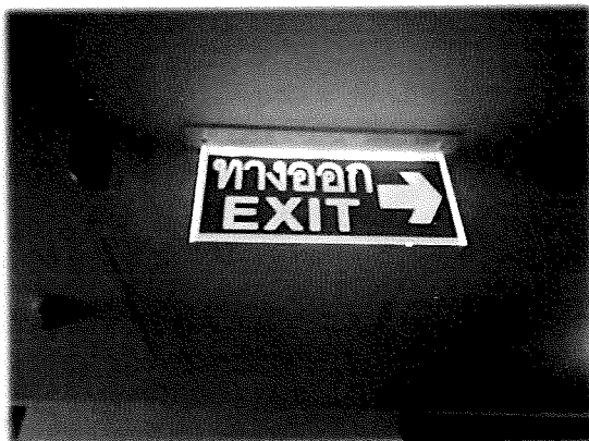
ชั้น 22 - บ้ายแสดงเส้นทางหนีไฟ
