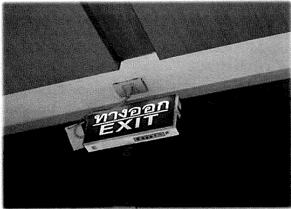
ชั้น G - ป้ายแสดงเส้นทางหนีไฟ
