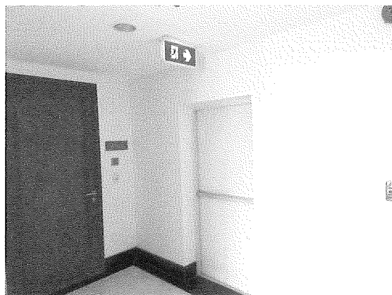
5. ประตูหนีไฟภายในอาคาร
