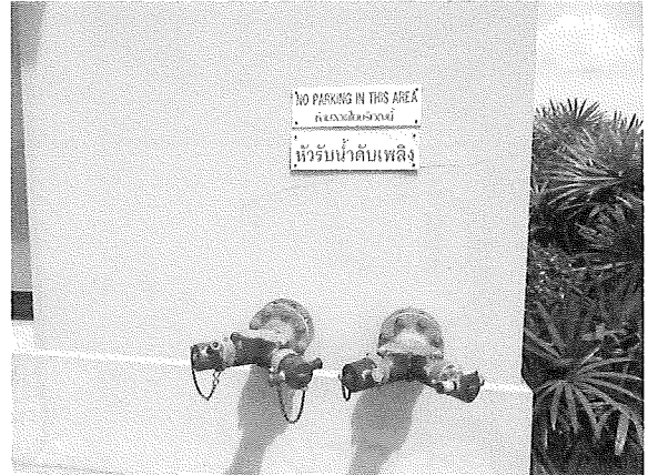
2. หัวรับน้ำดับเพลิง
