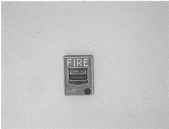
3. ปุ่มแจ้งเหตุเพลิงไหม้
