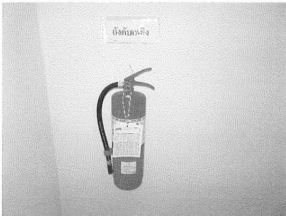
7. ถังกับเพลิงชนิด Dry Chemical
