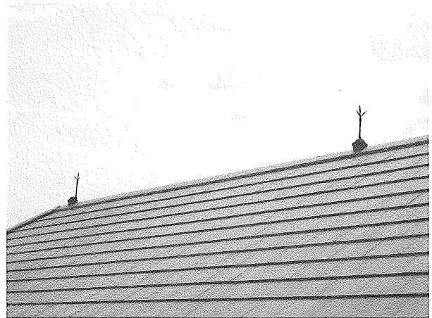
14. หลักล่อฟ้าชนิดฟาราเดย์
