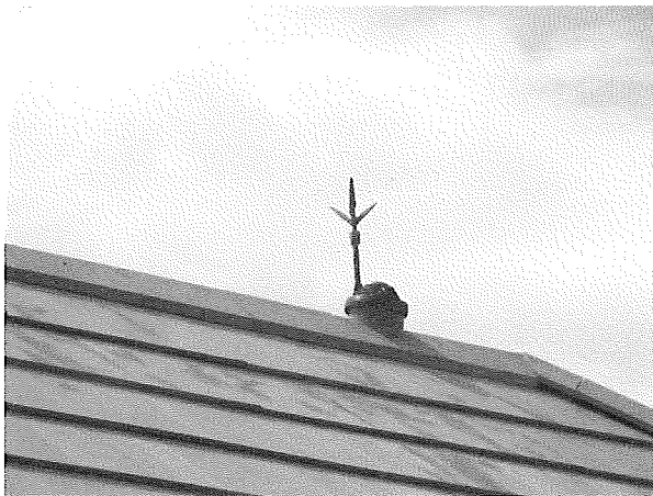
13. หลักล่อฟ้าชนิดฟาราเดย์
