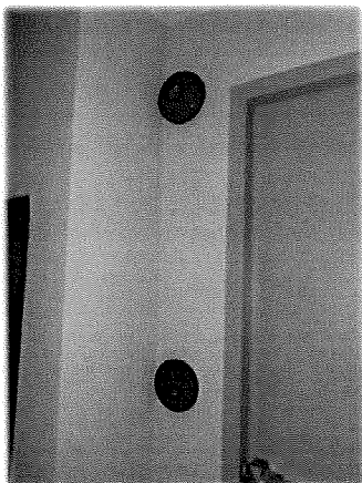
ชั้น 7 - สัญญาณแจ้งเหตุเพลิงไหม้
