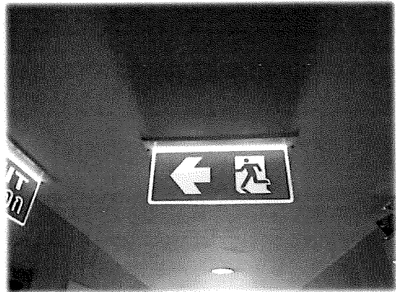
ชั้น 7 - ป้ายแสดงเส้นทางหนีไฟ
