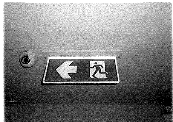
ชั้น 7 - ป้ายแสดงเส้นทางหนีไฟ
