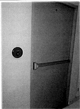
ชั้น 7 - ประตูหนีไฟ
