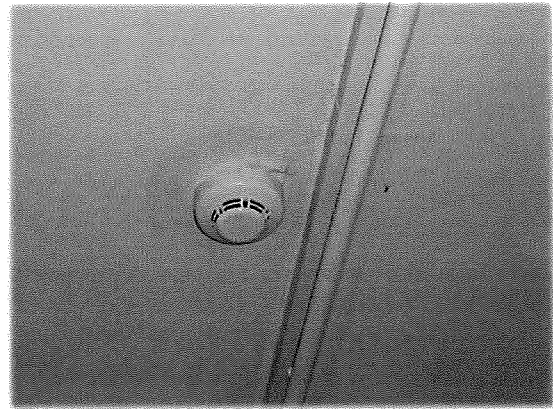
ชั้น 7 - อุปกรณ์ตรวจจับควัน
