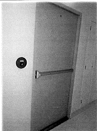
ชั้น 5 - ประตูหนีไฟ
