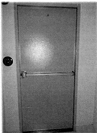
ชั้น 2 - ประตูหนีไฟ
