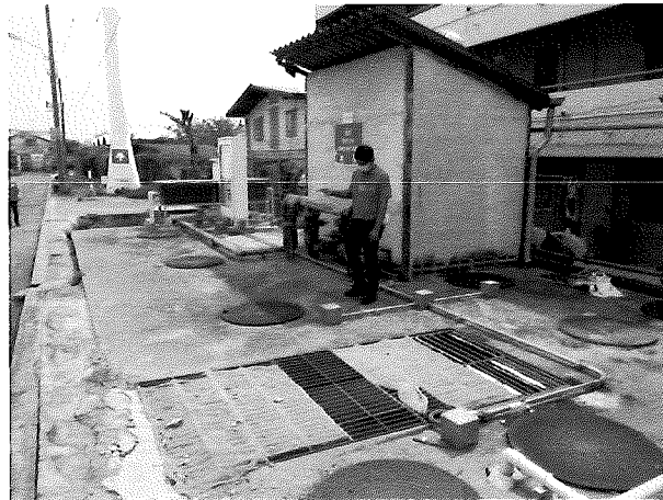
ระบบบำบัดน้ำเสีย พร้อมใช้งาน
