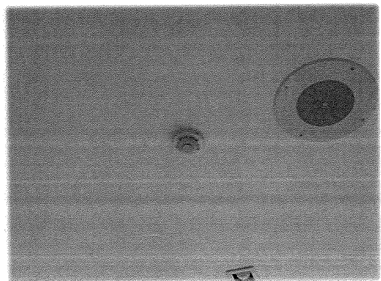
ชั้น 3 - อุปกรณ์ตรวจจับควัน
