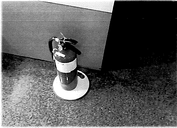
ชั้น 1 - ถังดับเพลิงเคมีชนิดมือถือ
