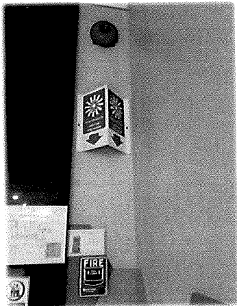
ชั้น 3 - สัญญาณแจ้งเหตุเพลิงไหม้
