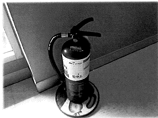
ชั้น 3 - ถังดับเพลิงเคมีชนิดมือถือ
