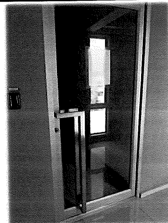
ชั้น 6 - ประตูหนีไฟ
