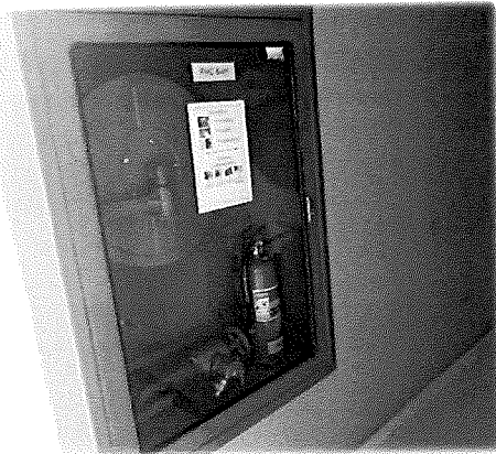
ชั้น 6 - ตู้ดับเพลิงและสายฉีดน้ำดับเพลิง
