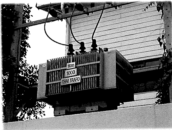
หม้อแปลงไฟฟ้า
