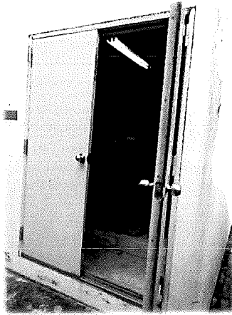
ห้องเครื่องปั๊ม
