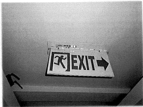
ชั้น 4 - บ้ายแสดงเส้นทางหนีไฟ
