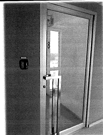
ชั้น 8 - ประตูหนีไฟ
