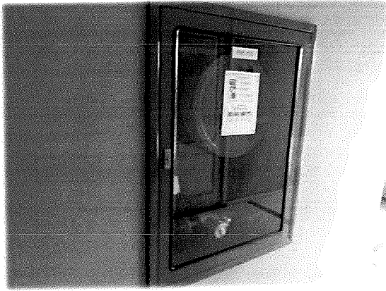
ชั้น 6 - ตู้ดับเพลิงและสายฉีดน้ำดับเพลิง
