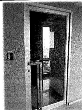
ชั้น 4 - ประตูหนีไฟ
