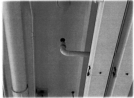
ชั้น 6 - สปริงเกอร์
