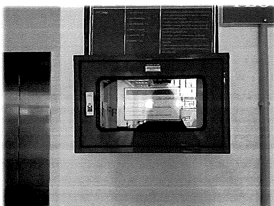
ชั้น 6 - ตู้เก็บอุปกรณ์ช่วยเหลือฉุกเฉิน
