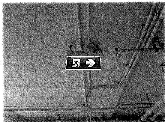
ชั้น 6 - บ้ายแสดงเส้นทางหนีไฟ
