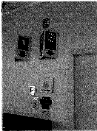
ชั้น 6 - สัญญาณแจ้งเหตุเพลิงไหม้
