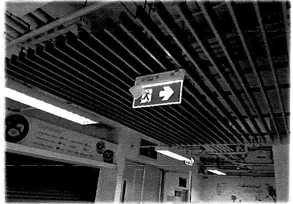
ชั้นใต้ดิน - บ้ายแสดงเส้นทางหนีไฟ
