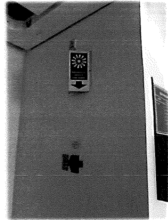
ชั้น 6 - สัญญาณแจ้งเหตุเพลิงไหม้
