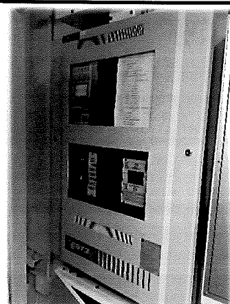
ชั้น 1 - ตู้ควบคุมระบบสัญญาณแจ้งเหตุเพลิงไหม้
