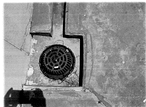
ชั้นดาดฟ้า - ระบบระบายน้ำฝน
