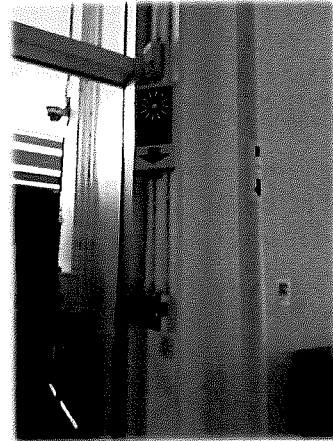
ชั้นใต้ดิน - สัญญาณแจ้งเหตุเพลิงไหม้
