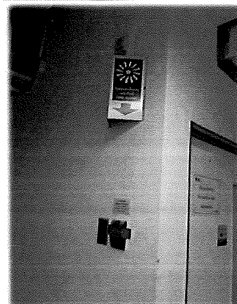
ชั้นใต้ดิน - สัญญาณแจ้งเหตุเพลิงไหม้
