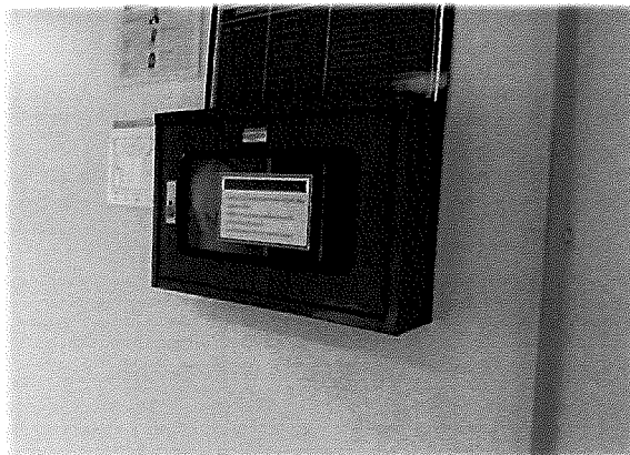
ชั้นใต้ดิน - ตู้เก็บอุปกรณ์ช่วยเหลือฉุกเฉิน
