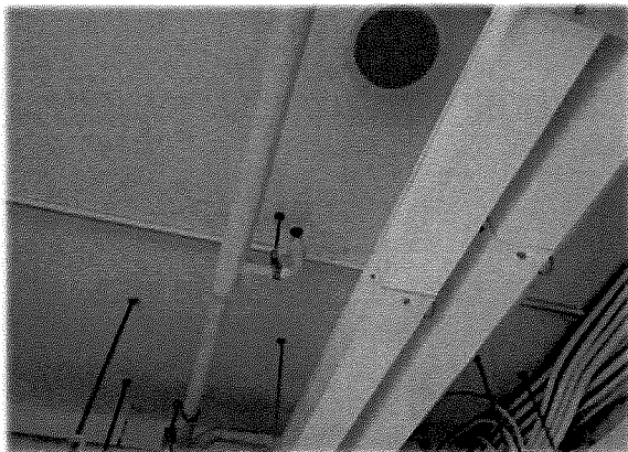
ชั้น 6 - สปริงเกอร์
