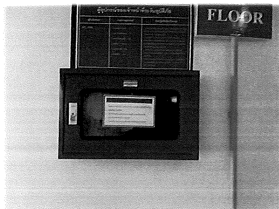
ชั้น 4 - ตู้เก็บอุปกรณ์ช่วยเหลือฉุกเฉิน
