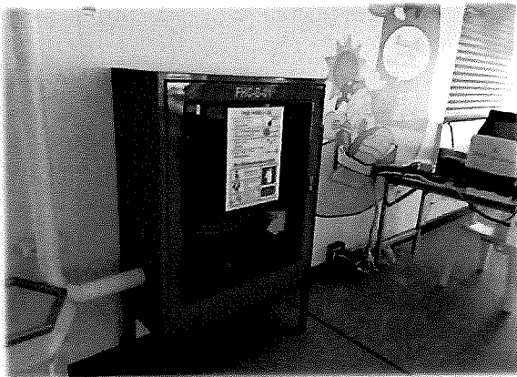
ชั้นใต้ดิน - ตู้ดับเพลิงและสายฉีดน้ำดับเพลิง
