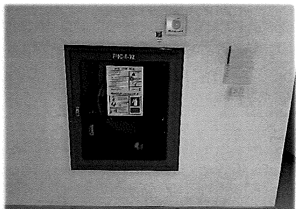
ชั้น 6 - ตู้ดับเพลิงและสายฉีดน้ำดับเพลิง
