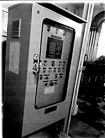
ชั้นดาดฟ้า - ตู้ควบคุมกระแสไฟฟ้าปั๊มเพิ่มแรงดันน้ำ
