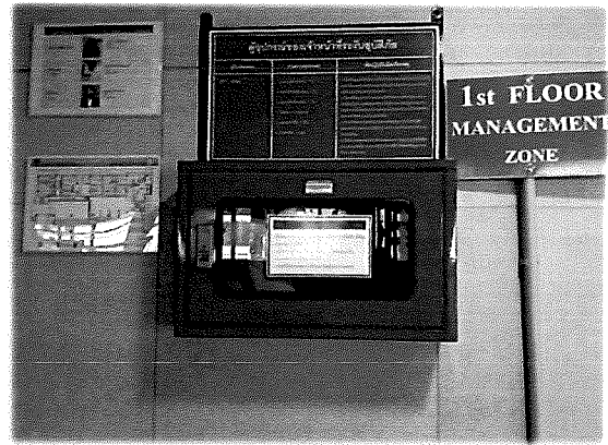
ชั้น 1 - ตู้เก็บอุปกรณ์ช่วยเหลือฉุกเฉิน
