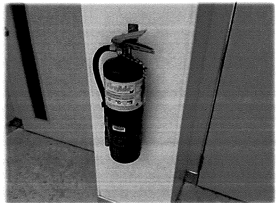
ชั้น 4 - ถังดับเพลิงเคมีชนิดมือถือ
