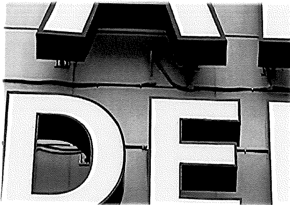
ขนาดสายไฟได้มาตรฐาน
