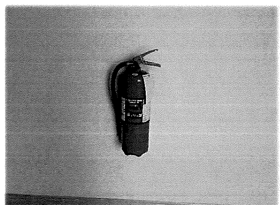
ชั้น 16 - ถังดับเพลิงเคมีชนิดมือถือ
