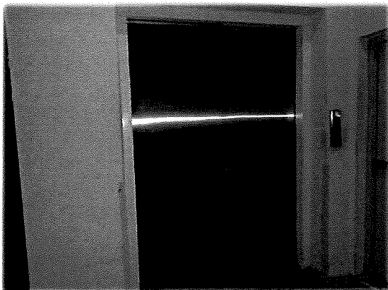
ชั้น 8 - ลิฟต์หนีไฟ
