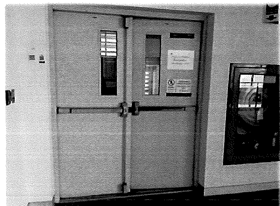
ชั้น 8 - ประตูหนีไฟ
