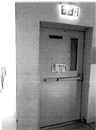
ชั้น 3 - ประตูหนีไฟ
