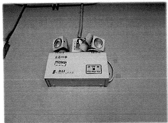
แสงสว่างฉุกเฉิน
