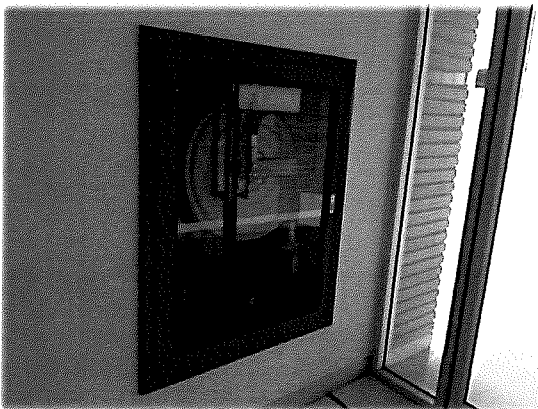
ชั้น 16 - ตู้ดับเพลิงและสายฉีดน้ำดับเพลิง
