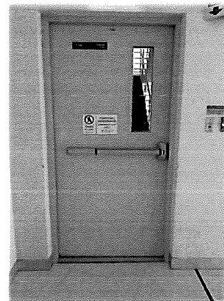
ชั้น 16 - ประตูหนีไฟ
