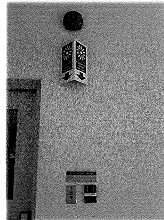
ชั้น 16 - สัญญาณแจ้งเหตุเพลิงไหม้
