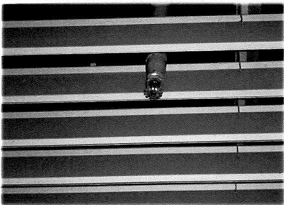
ชั้น 16 - สปริงเกอร์
