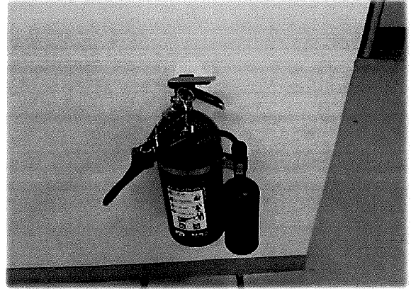
ชั้น M2 - ถังดับเพลิงเคมีชนิดมือถือ
