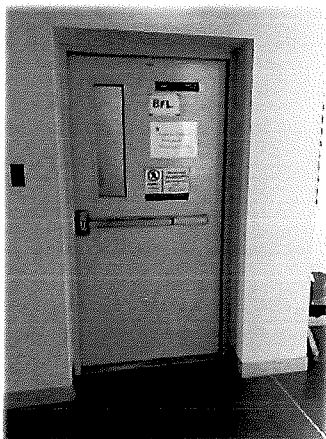
ชั้น 8 - ประตูหนีไฟ
