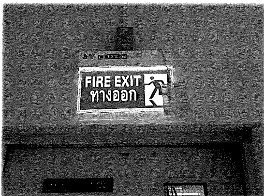
ชั้น 16 - บ้ายแสดงเส้นทางหนีไฟ
