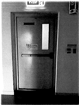
ชั้น 3 - ประตูหนีไฟ
