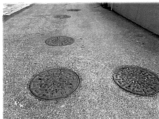
บ่อบำบัดน้ำเสีย
