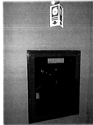
ตู้ดับเพลิงและสายชนิดน้ำดับเพลิง
