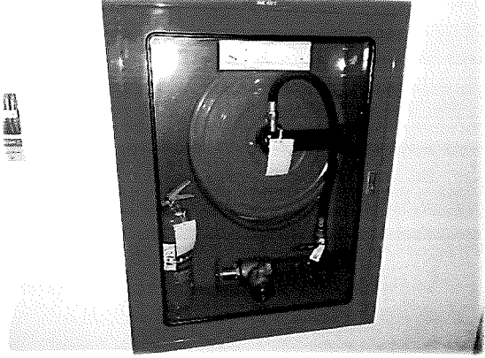
ชั้น 3 - ตู้ดับเพลิงและสายฉีดน้ำดับเพลิง
