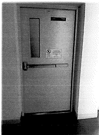
ชั้น 16 - ประตูหนีไฟ
