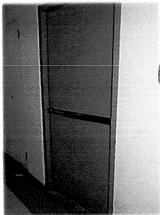
ชั้น 4 - ประตูหนีไฟ
