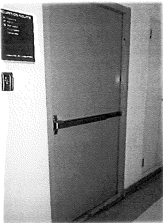
ชั้น 6 - ประตูหนีไฟ
