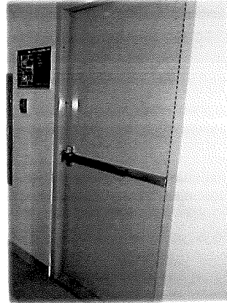
ชั้น 2 - ประตูหนีไฟ
