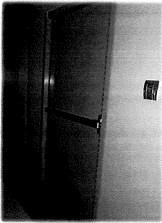
ชั้น 2 - ประตูหนีไฟ
