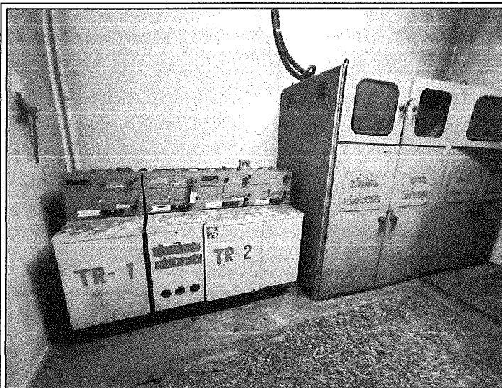
รูปภาพแสดงการตรวจสอบ ตรวจวันที่ 10 พฤศจิกายน 2563 เรื่อง ระบบไฟฟ้า
